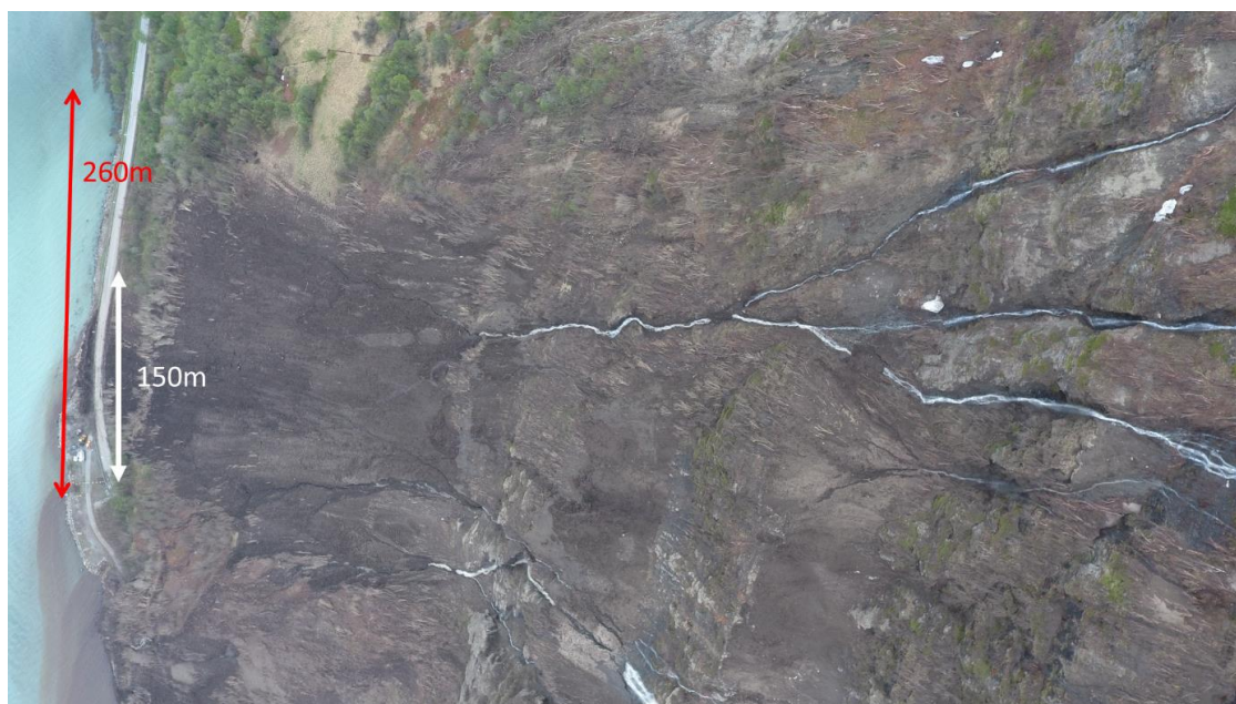
Figur 3: Den 1. juni 2020 gikk det et stort skred som berørte ca. 250 meter av vegen. Det er 20 - 30 år siden sist et så stort skred traff vegen sist. For mer info om skredet: https://www.regobs.no/Registration/237836 . Dronefoto av Peter Bruvold.
