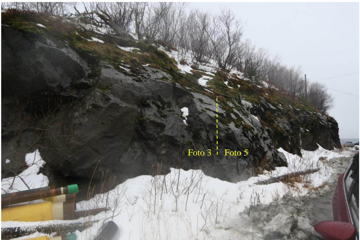
Foto 4. Foto tatt mot NV. Liten oppsprekking.
