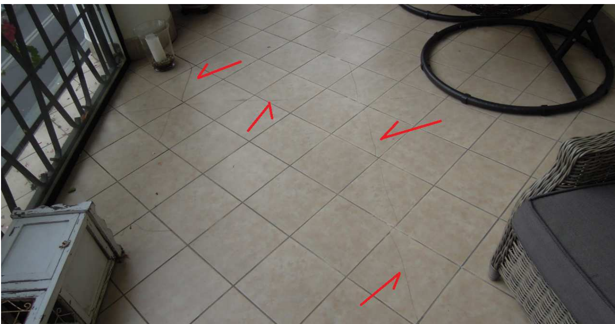
Widoczna popękana posadzka tarasu w poziomie I piętra.
