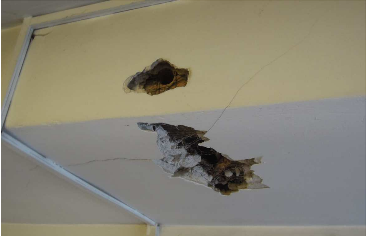
Widoczne drewniane obniżenie stropu obok podciągu, w miejscu wycofania ściany piętra.
