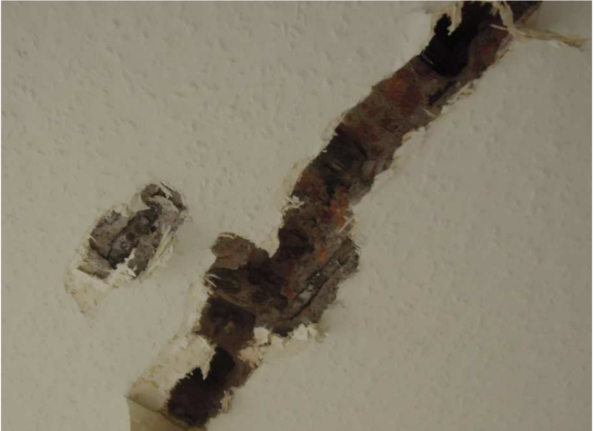
Widoczne zbrojenie dolne żebra stropu skrzynkowego – odkrywka O.11, beton z wykorzystaniem gruzu ceglanego.
