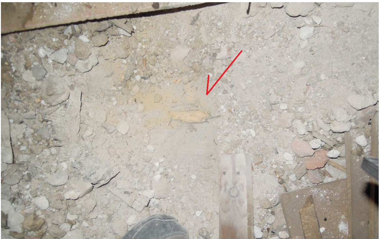
Widoczna polepa gruzowa i belki drewniane stropu poddasza. Widoczna jest ich powierzchniowa korozja.
