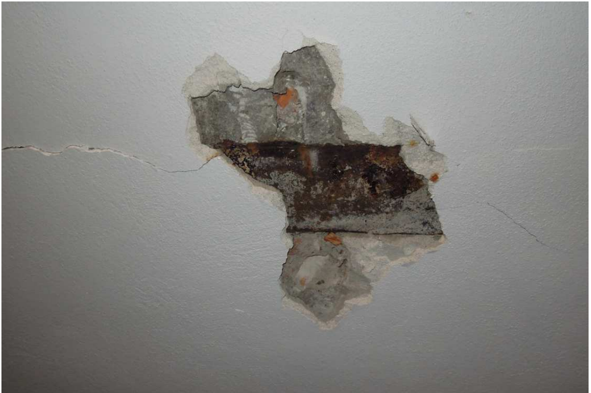
Widoczne pęknięcie tynku i skorodowane dolna półka belki stropowej w stropie przejazdu bramowego – odkrywka O.3.
