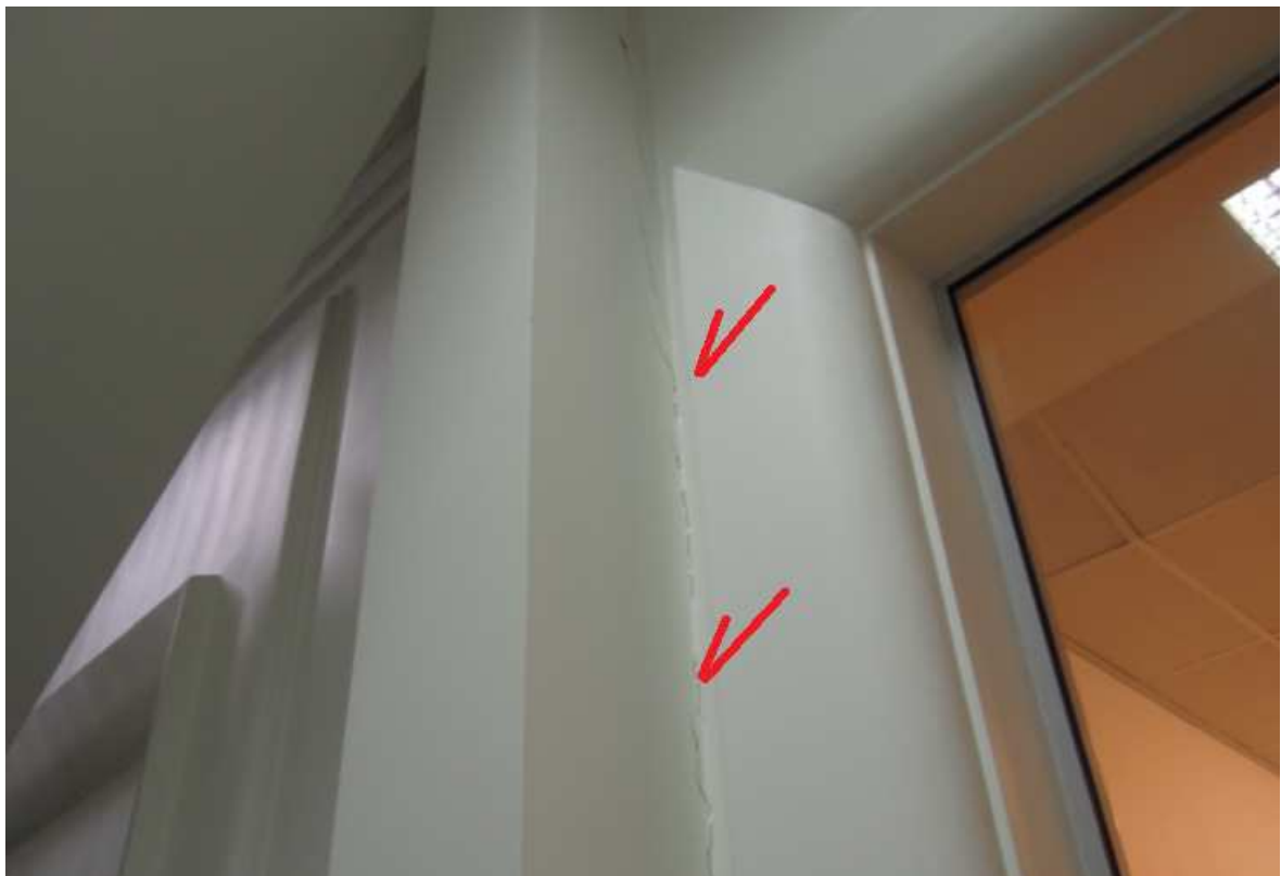
Widoczne zarysowania na styku klatki schodowej D z budynkiem ambasady.
