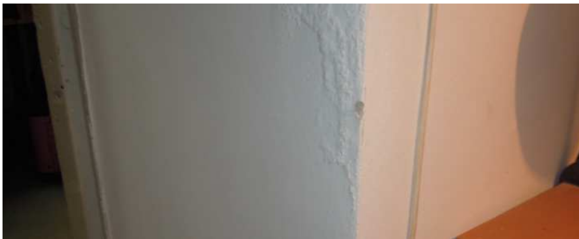
Widoczne zawilgocenie ścian piwnicy w rejonie przejazdu bramowego.
