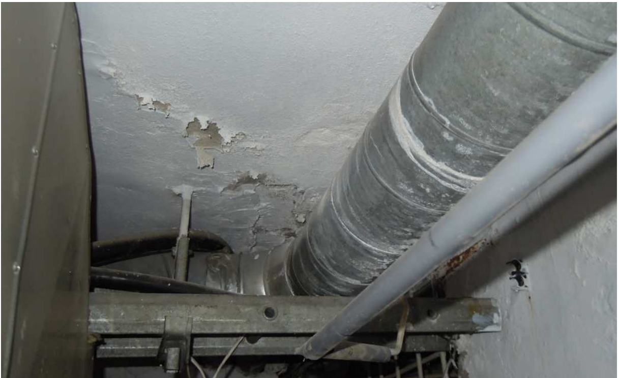
Widoczne zawilgocenie stropu pod przejazdem bramowym.
