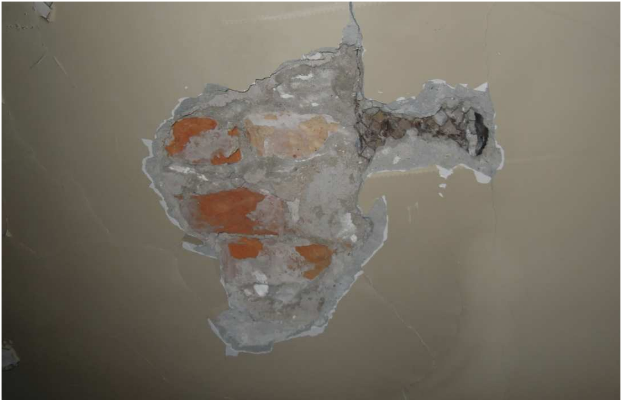
Widoczna odkrywka O.6 stropu Kleina, z płytą ceglana. Widoczna jest osiatkowana dolna półka belki stropowej.
