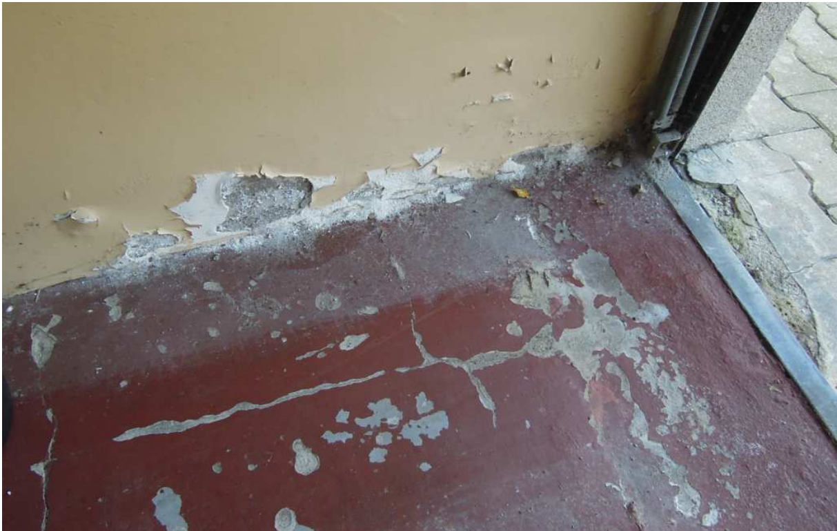
Widoczny zawilgocony tynk przy posadzce garażu.
