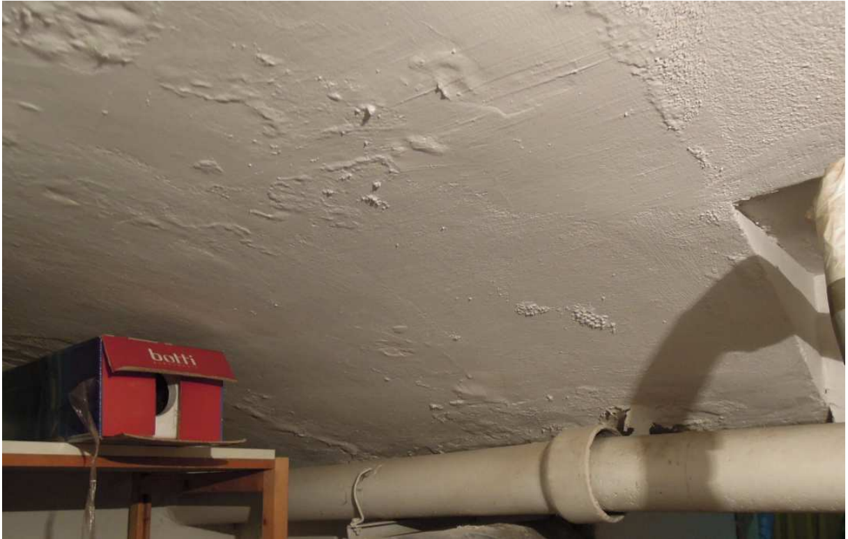
Widoczne zawilgocenie sklepienia ceglanoego stropu pod przejazdem bramowym.
