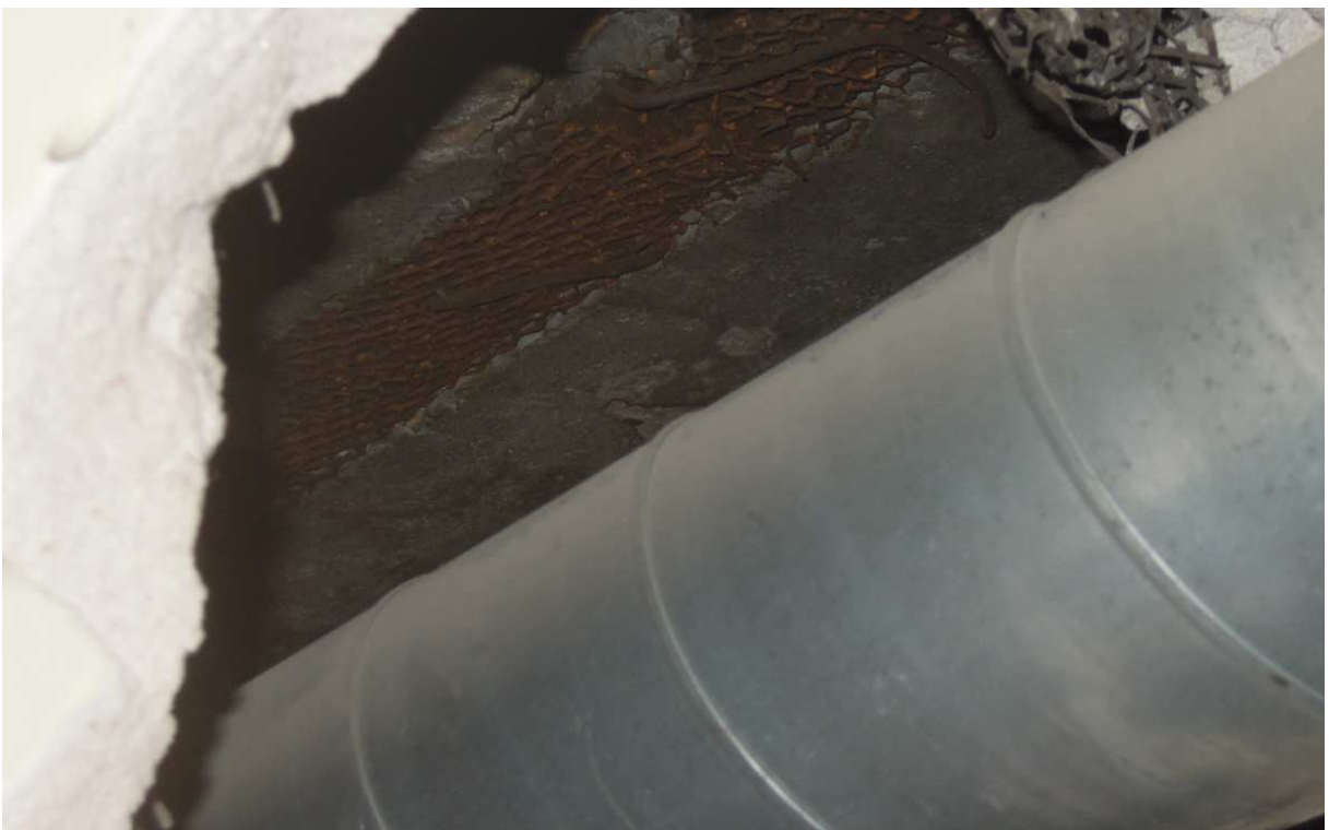
Widoczna skorodowana półka belki stropowej, nieosłonięta tynkiem w stropie nad parterem.
