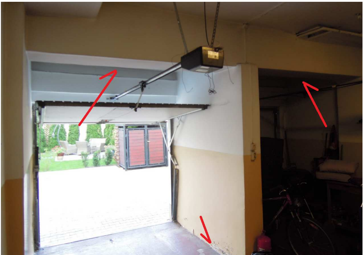
Widoczne zawilgocenie ściany przy posadzce oraz podciągi na belkach stropowych żelbetowych, zalanych betonem.
