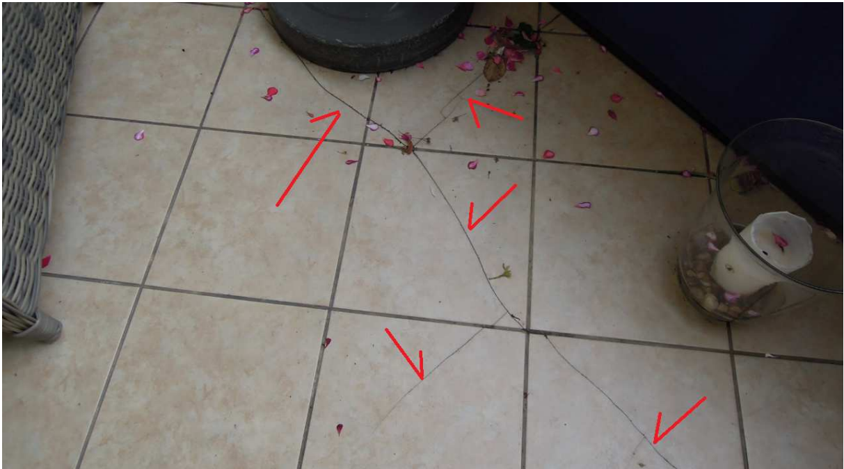
Widoczna popękana posadzka tarasu w poziomie I piętra.
