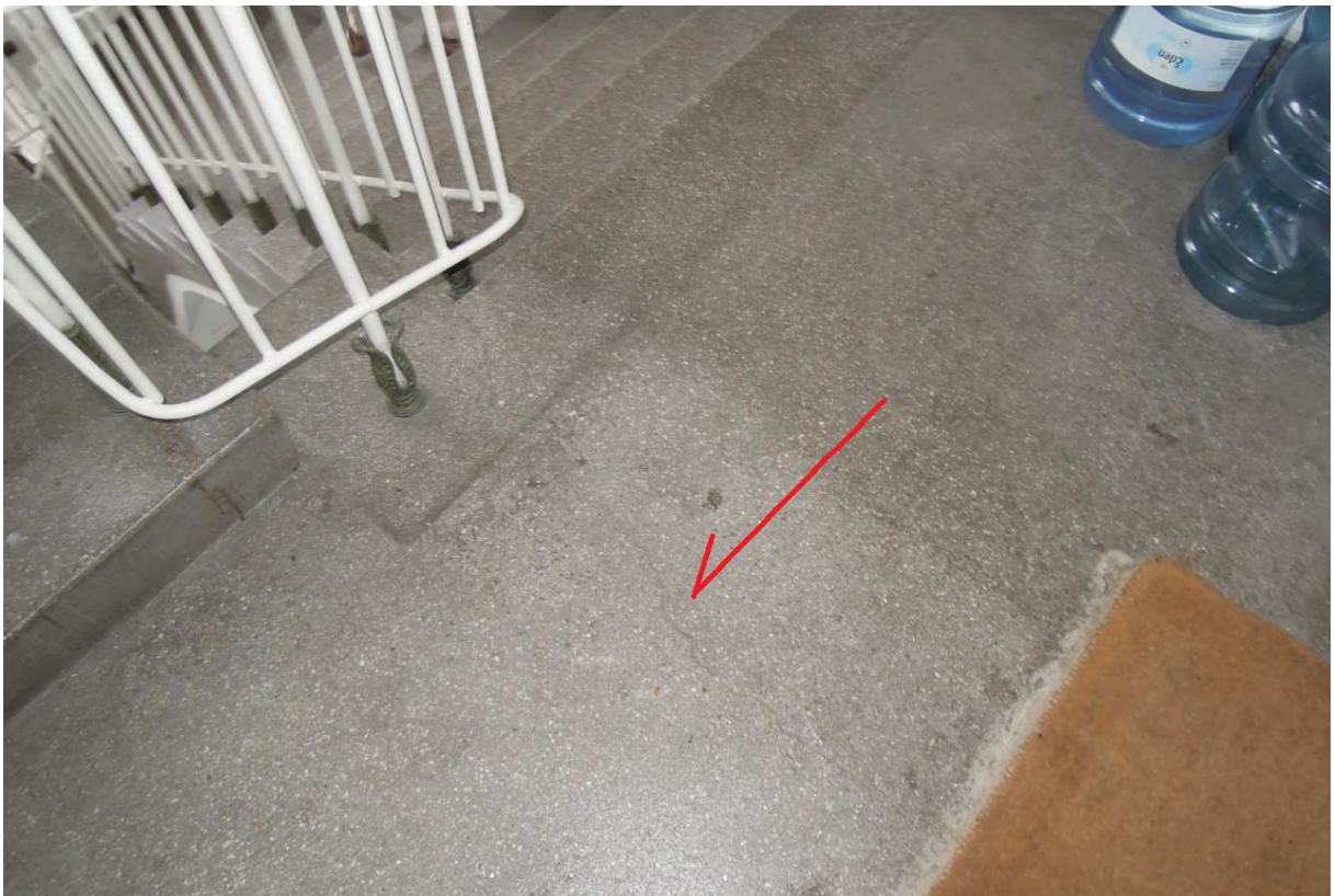
Klatka schodowa B, widoczne pęknięte lastryko na spoczniku w poziomie I piętra.
