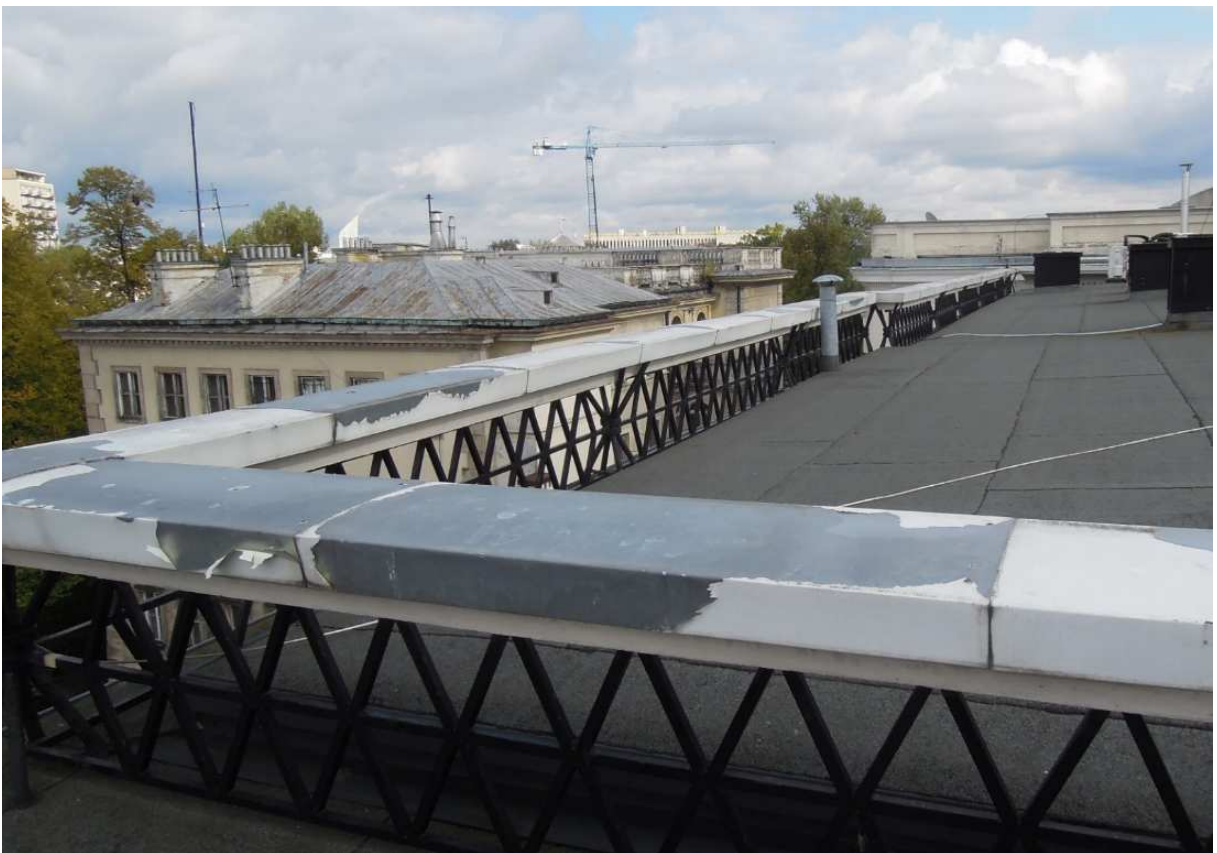
Widoczna łuszcząca się farba z ocynkowanych obróbek blacharskich.
