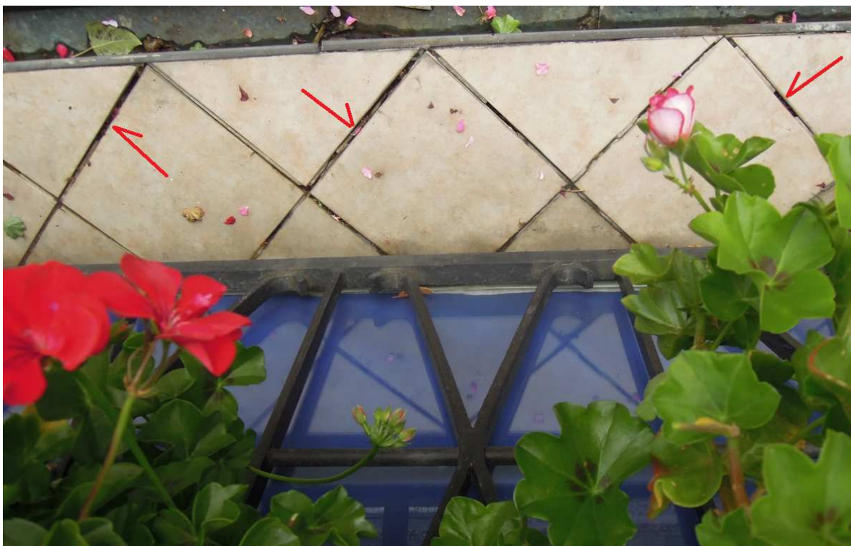
Widoczna ubytki fugi w posadzce tarasu w poziomie I piętra.
