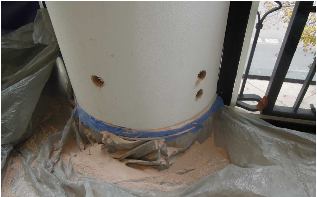
Widoczne odwierty słupa w poziomie I piętra. Stwierdzono występowanie dwugąłęziowego słupa stalowego obmurowanego cegłą pełną.
