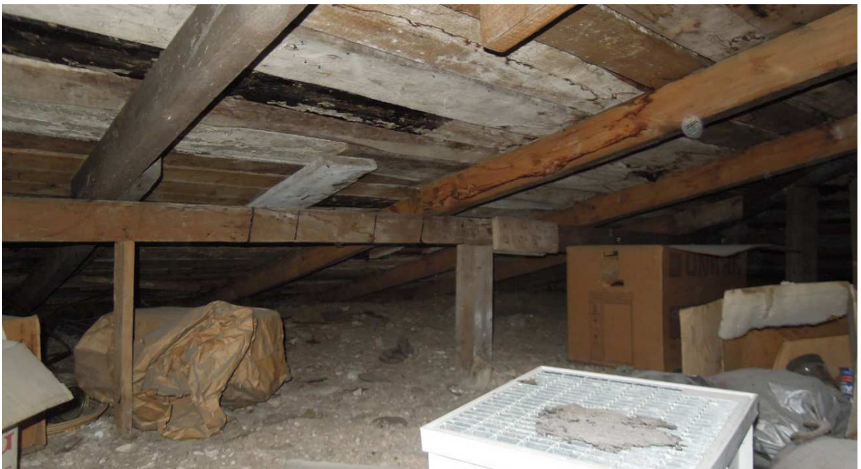
W poziomie poddasza występuje polepa. Widoczne składowanie różnych rzeczy na stropie poddasza.
