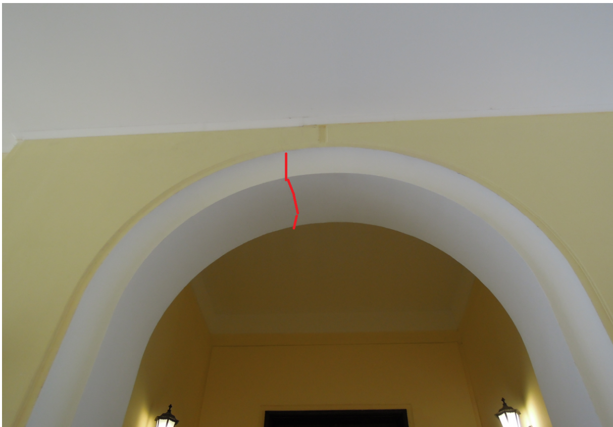
Widoczne zarysowanie nadproża łukowego w przejeździe bramowym.
