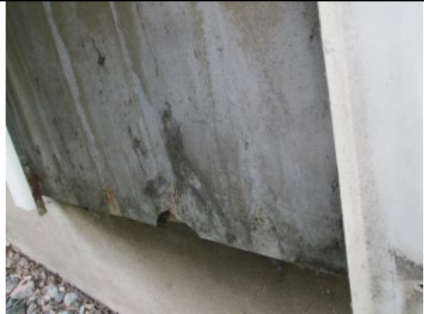
Bilde 3 Internitplate bak metallplater på fasade
