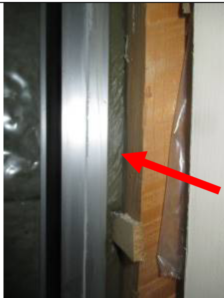
Bilde 4 Fuge/tettemasse mellom vindu og foring
