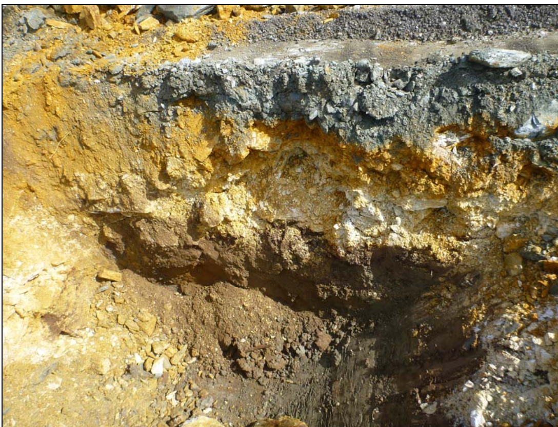
Figur 4 Sjakt i punkt 9: grove fyllmasser av sprengstein over stedlig grunn av siltig leire. Tydelig rustutfelling fra sprengsteinen.
