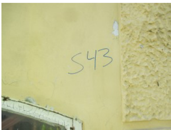
Bilde 3.22 Utvendig maling skolebygg - farlig avfall
