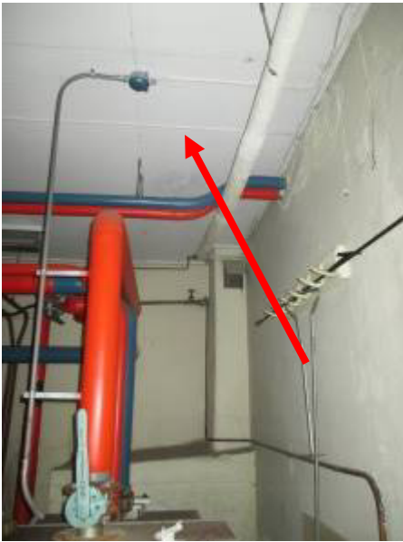
Bilde 3.7 Asbestholdige himlingsplater fyrrom
