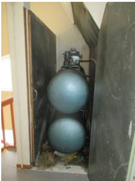
Bilde 3.5 Vegger og dør trykkluft kledd med asbestholdige plater på utside
