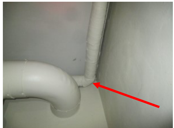
Bilde 3.6 Rørbend som kan inneholde asbest
