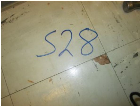
Bilde 3.3 Vinylflis som er asbestholdig
