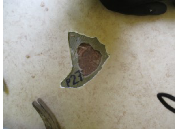
Bilde 3.2 Asbestholdig gulvbelegg
