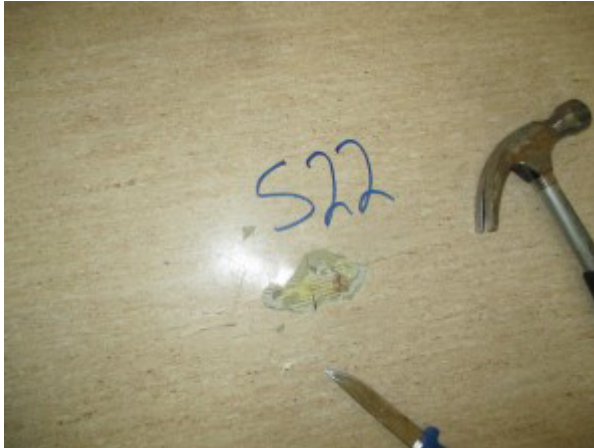
Bilde 3.1 Vinyl som er asbestholdig
