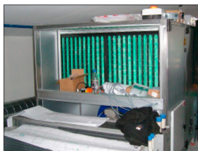
Ventilasjonsaggregat må forsegles for å hindre støvinntrenging
