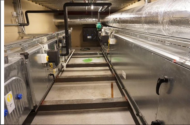
Ventilasjonsrom teknisk mellometasje isolater
