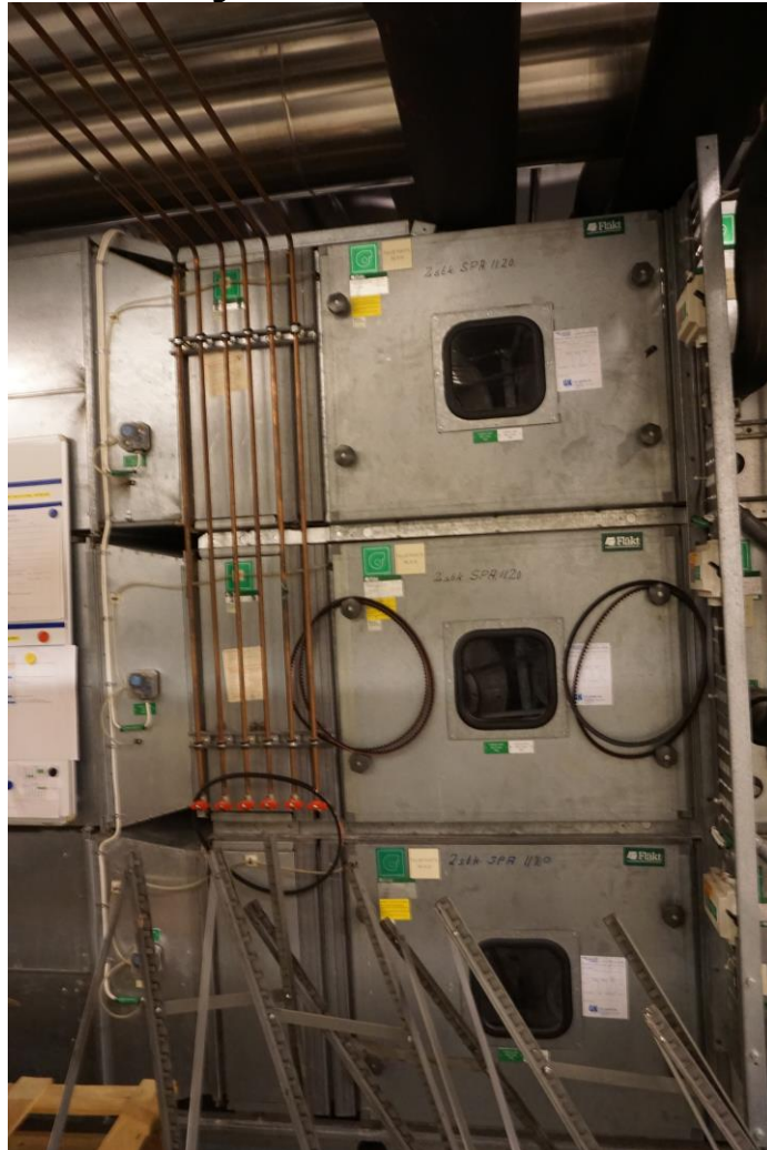
Nye ventilasjonsaggregater for bygg 10 SSK
