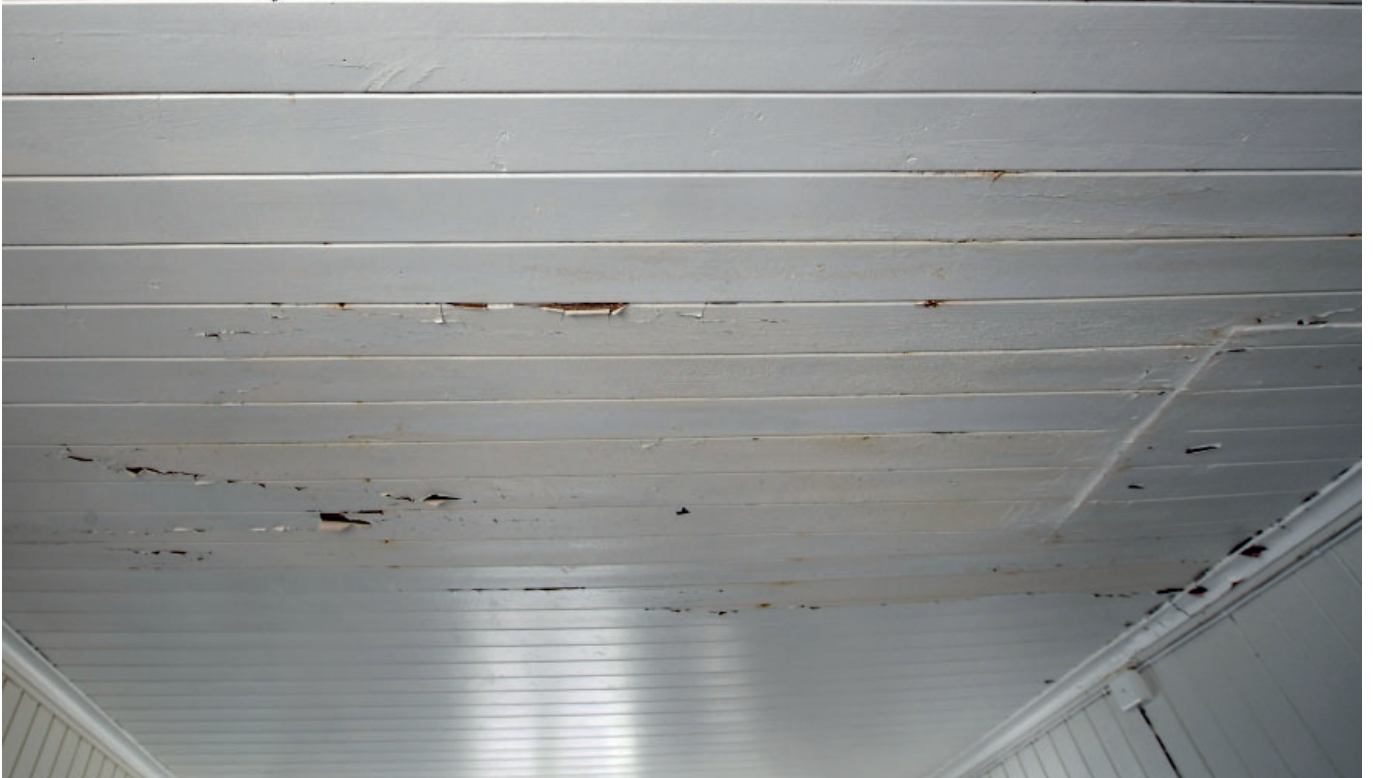
Bilde 5. Bilde av skade på himlingen.
