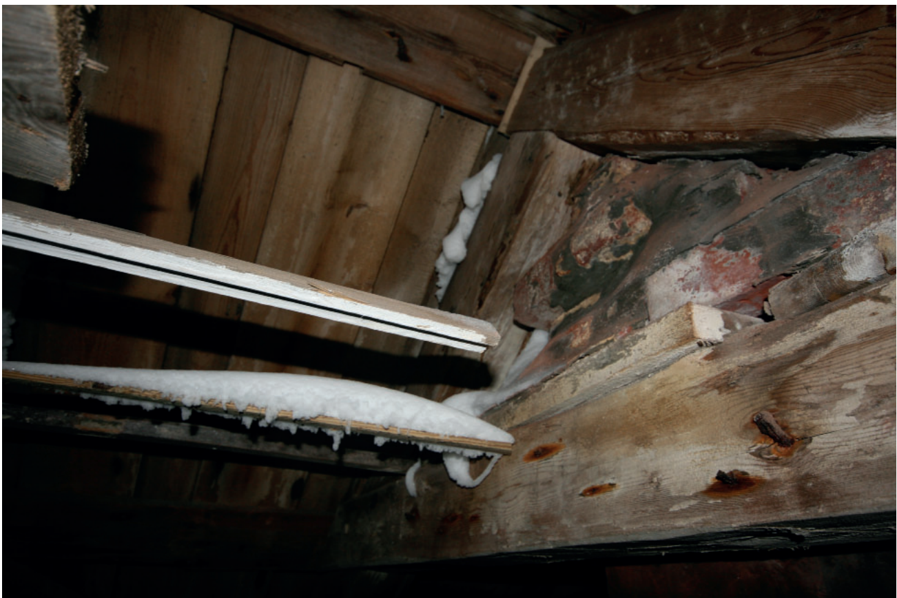
Bilde 12. Samme vinteren, snø under taket.
