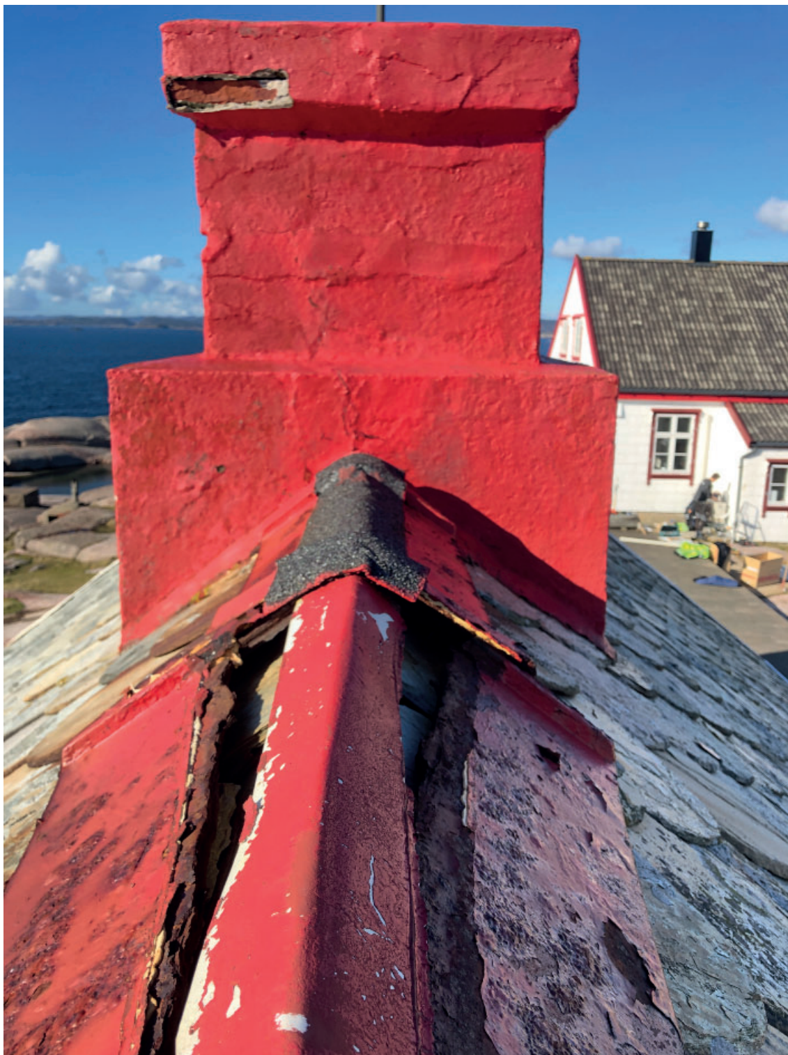
Bilde 9. Nærmere bilde av sprukket mønepanne og mønebjelke.
