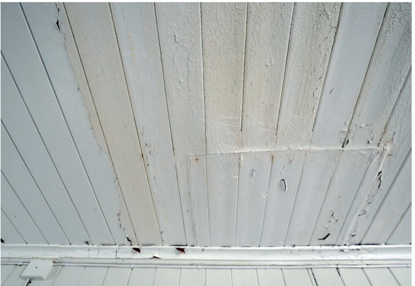
Bilde 6. Bilde av skade på himlingen, annen vinkel.
