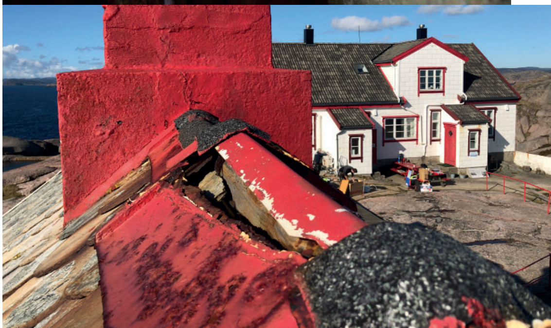
Bilde 8. Nærmere bilde av sprukket mønepanne og mønebjelke. Stor sprekk i mønebjelke.
