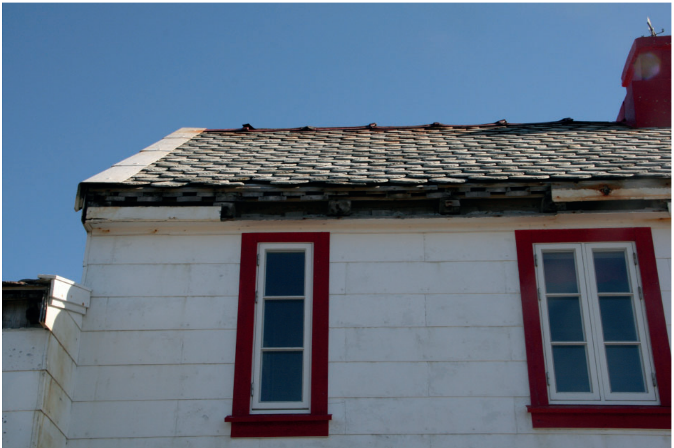
Bilde 3. Nærmere bilde av skaden, manglende pannebord og takrenne, fasade mot sørvest.
