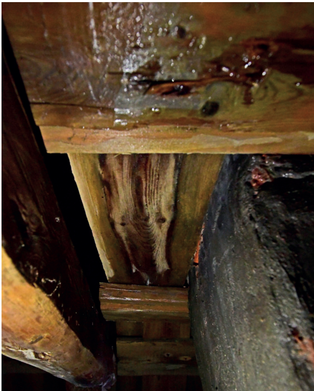
Bilde 7. Bilde av lekkasjen like under sprukket mønepanne og mønebjelke. Lekkasken blir forverret ved mye vind med ugunstig vindretning.
