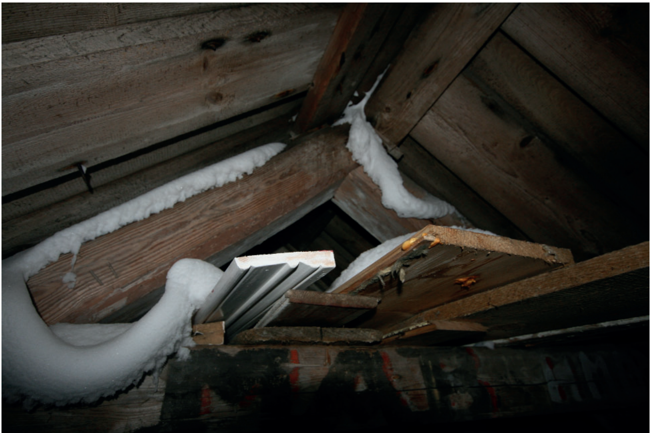
Bilde 11. Vinter i 2010, det snødde inn i loftet som tyder på at taket ikke er tett.
