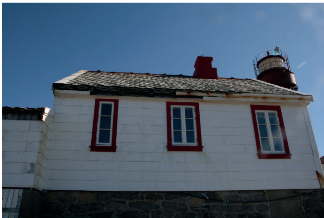
Bilde 2. Noe skifer takstein har blitt blåst av og et stykke pannebord mangler. Fasade bilde mot sørvest.
