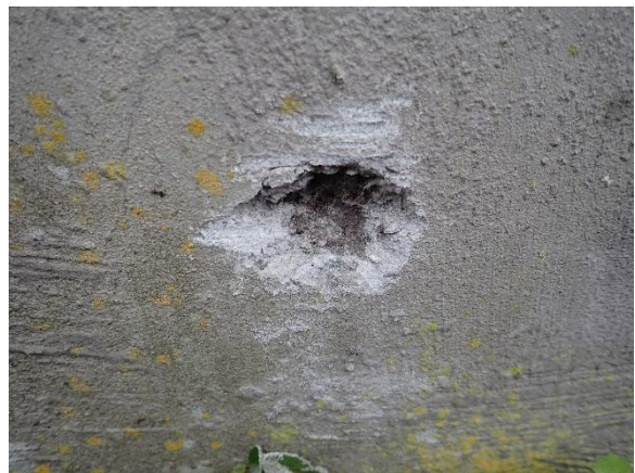
Bilde B14: P10 – Utvendig puss på grunnmur, tilbygg.
