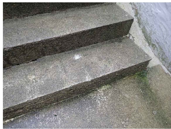
Bilde B18: P12 – Betong fra utvendig trapp, påbygg nordsiden. Denne betongen har høyt innhold av krom 6 og kan ikke gjenbrukes.
