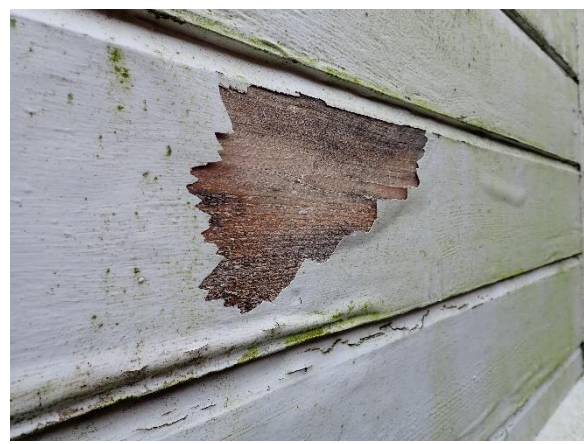
Bilde B20: P13 – Hvit maling på trekledning fasade.
