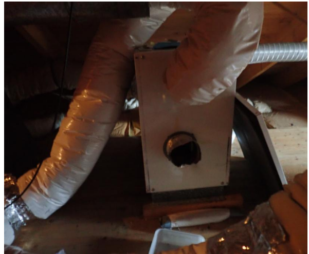
Bilde B38: Tidligere ventilasjonsanlegg står fortsatt på loftet.
