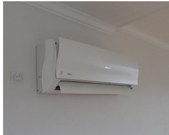
Bilde B36: Varmepumpe i 1.etg.
