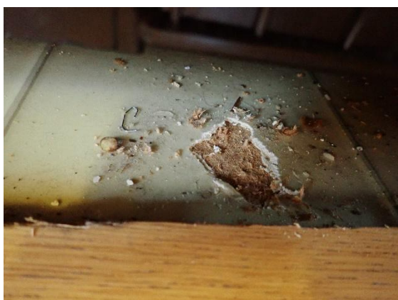
Bilde B3: P02 – Gulvbelegg under kjøkkenbenk, plan 1.
