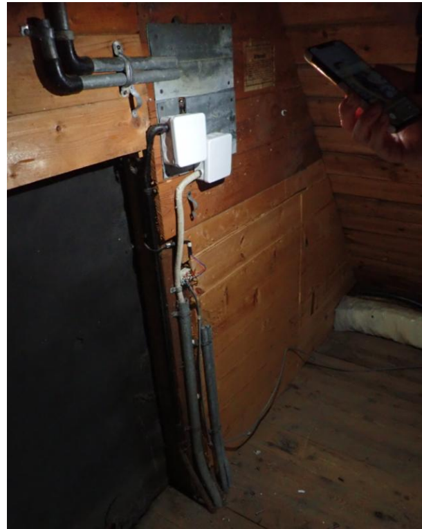
Bilde B34: Sannsynlig asbestholdig isolering på strømledning, ledning fortsetter ned til etasjene i trekkerør.
