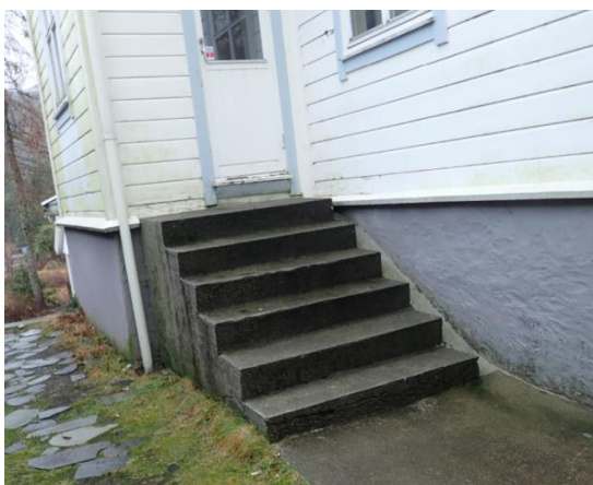
Bilde B19: P12 – Betong fra utvendig trapp, påbygg nordsiden. Denne betongen har høyt innhold av krom 6 og kan ikke gjenbrukes.
