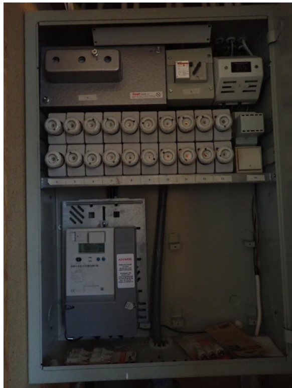
Bilde B24: Eldre sikringskap, vindfang ved inngang kjeller.
