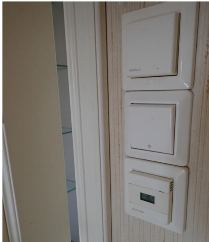
Bilde B37: Varmekabler i gulv på bad.
