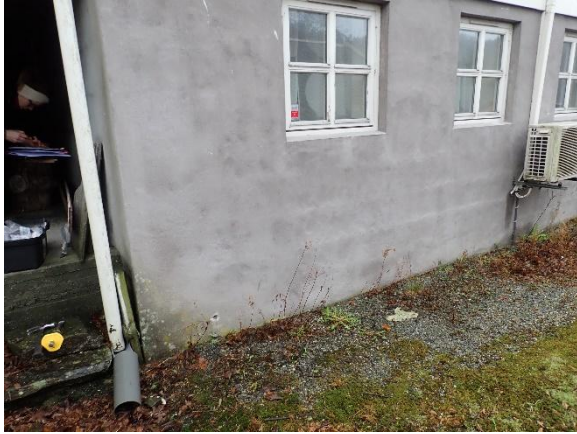
Bilde B15: P10 – Utvendig puss på grunnmur, tilbygg.
