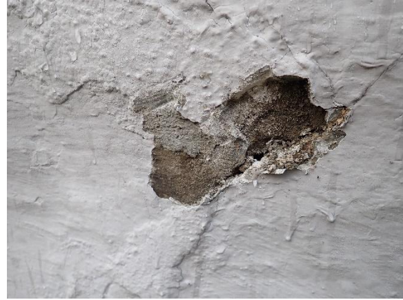
Bilde B16: P11 – Utvendig puss på grunnmur, gamledel.
