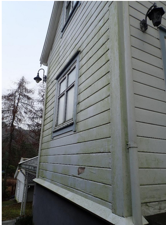
Bilde B21: P13 – Hvit maling på trekledning fasade.
