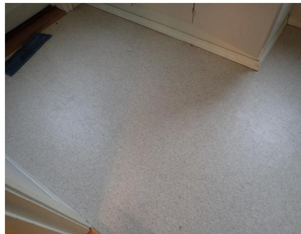
Bilde B28: Vinylbelegg ved inngang i påbygg, 1.etg.
