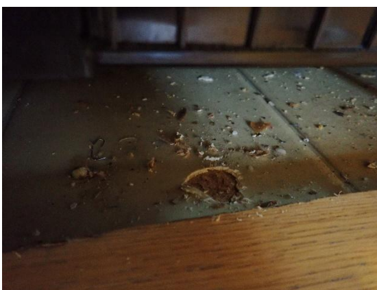
Bilde B4: P02 – Gulvbelegg under kjøkkenbenk, plan 1.
