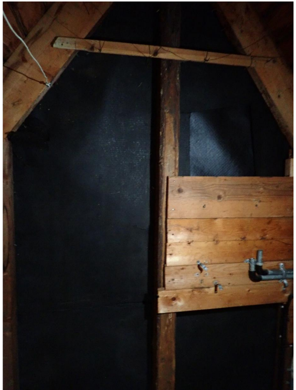
Bilde B6: P03 – Svart papp i yttervegg, gamledel bolighus, her fra loft.
