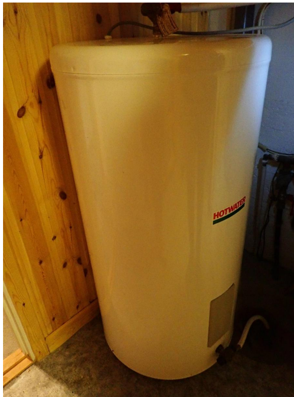
Bilde B23: Varmtvannsbereder i kjeller, fra 1991.
