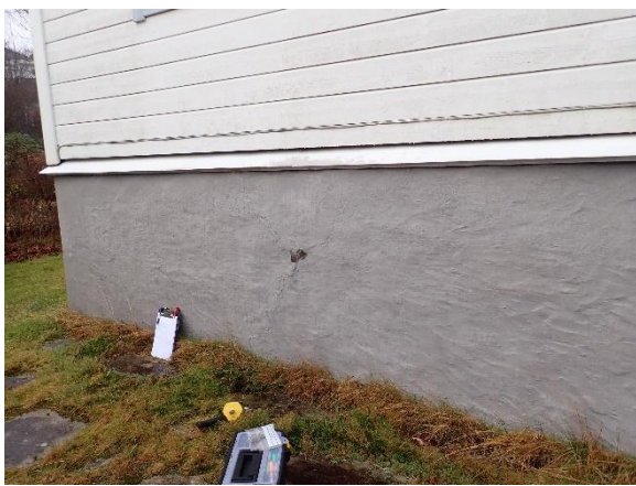
Bilde B17: P11 – Utvendig puss på grunnmur, gamledel.
