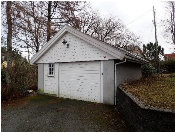
Bilde B11: P08 – Murpuss vegg garasje.
