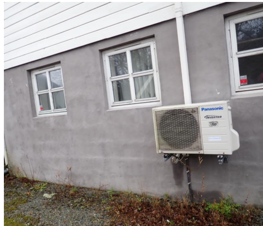
Bilde B40: Grunnmur tilbygg. Varmepumpe.
