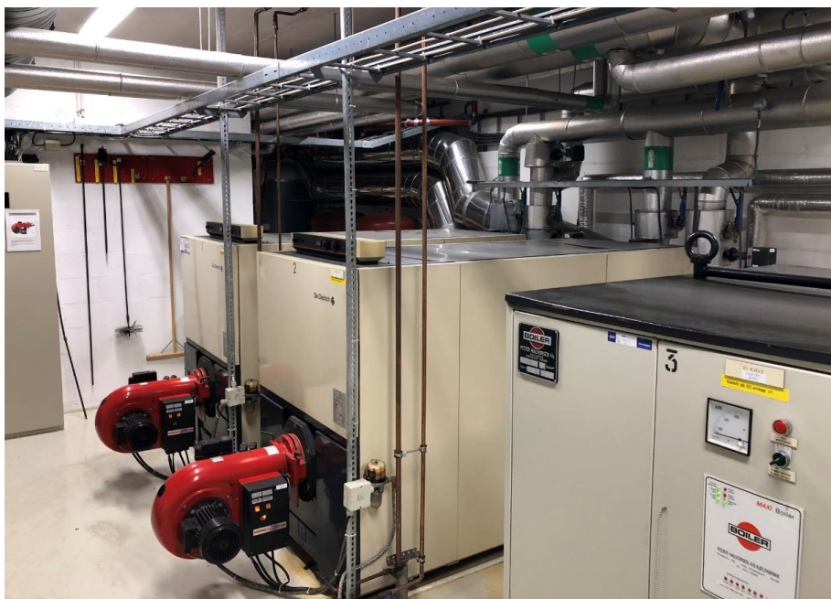
Kjelanlegg – oljekjeler til venstre skal fjernes for å gi plass til varmepumpe
