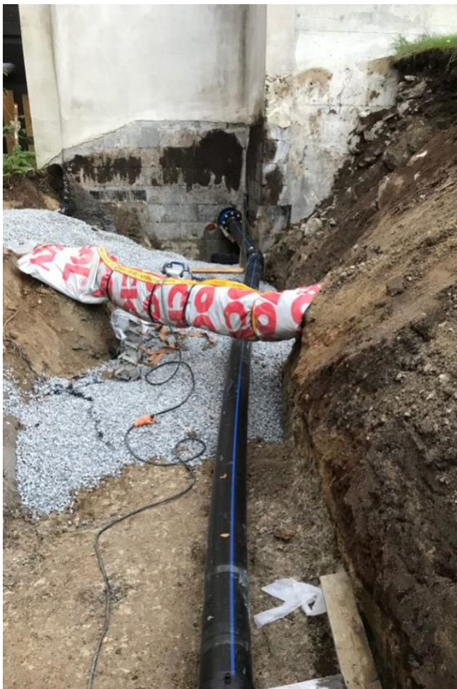
Figur 28: 160 mm sprinkler med høyspentkryssing
