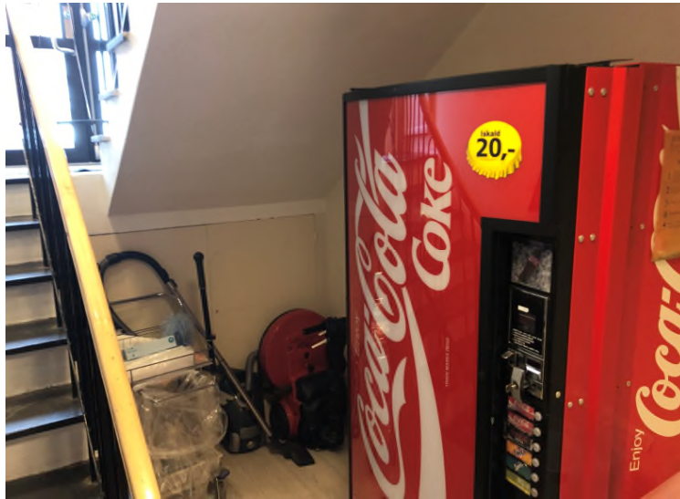
Unødig brannenergi og lagring i rømningsvei må fjernes.
