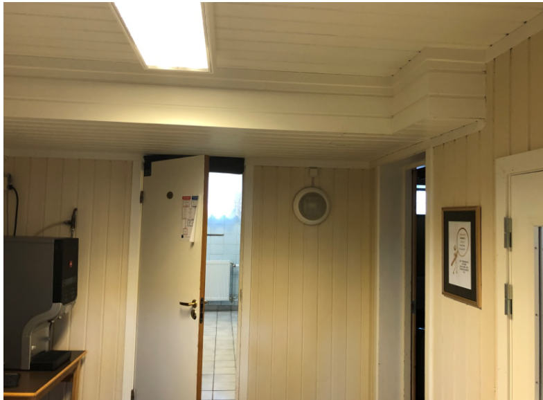
Overflater i rømningsvei oppgraderes – innkassede gjennomføringer må undersøkes/tettes.
