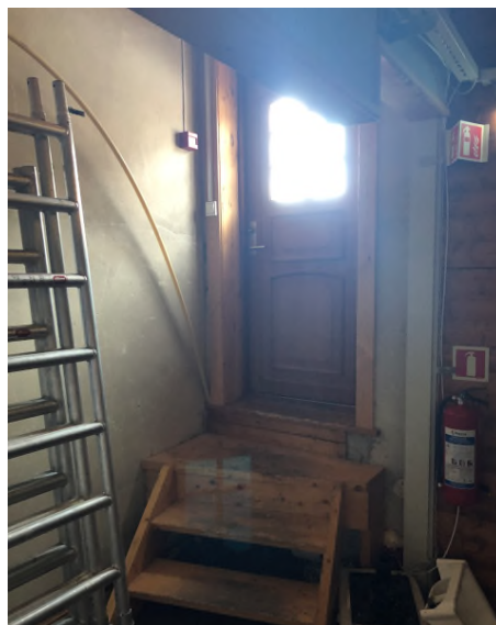
Unødvendig lagring i fluktrute må fjernes.
