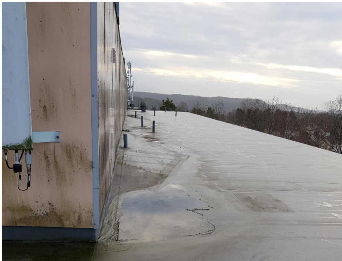
Figur 19 Eksisterende tak over helsehuset, sett mot sørvest. Her skal slukene skiftes ut.
