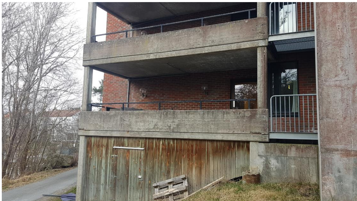
Figur 20 Balkonger i sør som skal rehabiliteres. Merk at balkong i plan 2 skal bygges inn (spiserom).
