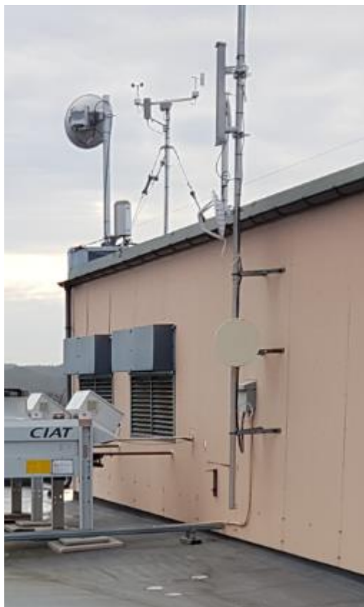
Figur 23 Deler av antenneanlegget på tak vises her. Alle fasader rundt teknisk rom har antenneanlegg
