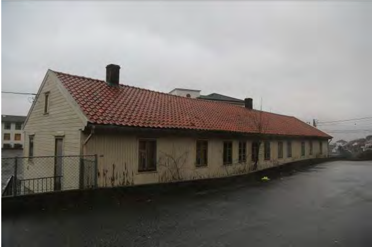
Figur 6 Langfasaden mot sør. Lemmekonstruksjonen er kledd med stående trepanel, dette er originalt. Kortveggene har fått nytt, liggende panel.
