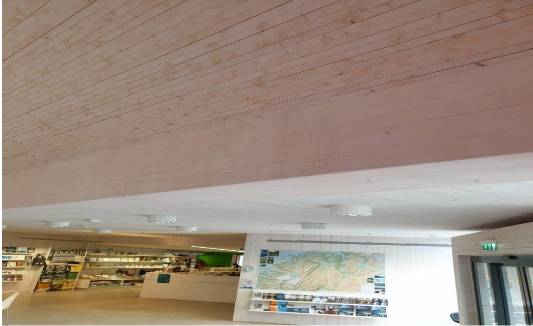
Figur 11: Bilde av limtretrager med synlige fuktmerker fra taklekkasjer.
