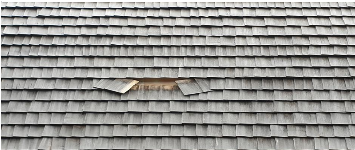
Figur 2: Løsnet trespon på yttertak mot vest.
