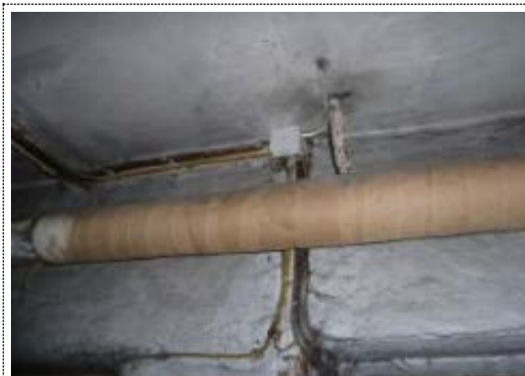
963.03 Kabelinstallasjon i fyrrom
