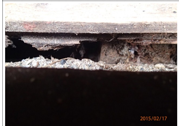
Bilde nr. 720.04 Utendørs konstruksjoner Råteskade på gulv i bod.
