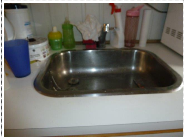
Bilde nr.310.18 Kjøkkenvask på avdelingskjøkken.
