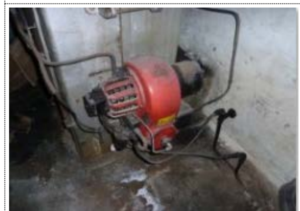
963.01 Motor for fyranlegg i fyrrom
