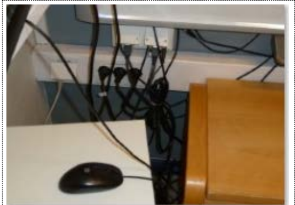
Bilde nr.520.02 Tele og data uttak ved smartboard
