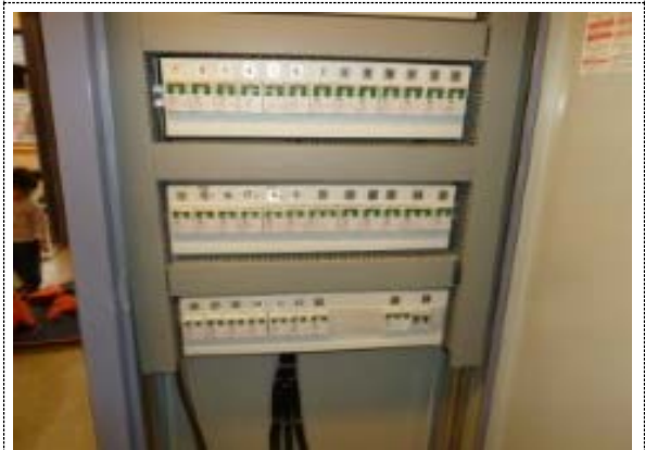
Bilde nr.410.01 Fordelingskap
