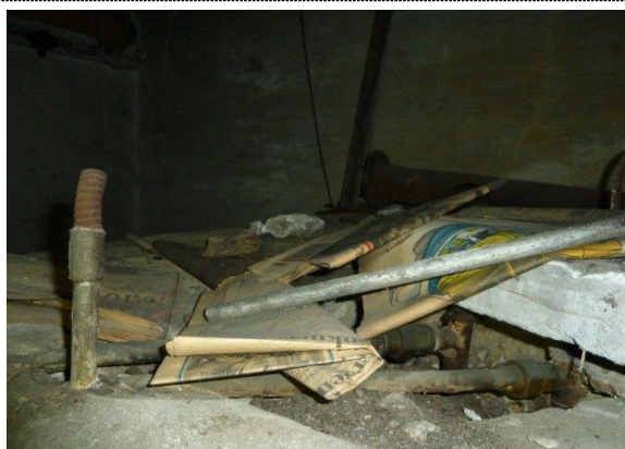
Bilde nr.690.02 Tilførsel og retur på oljetank
