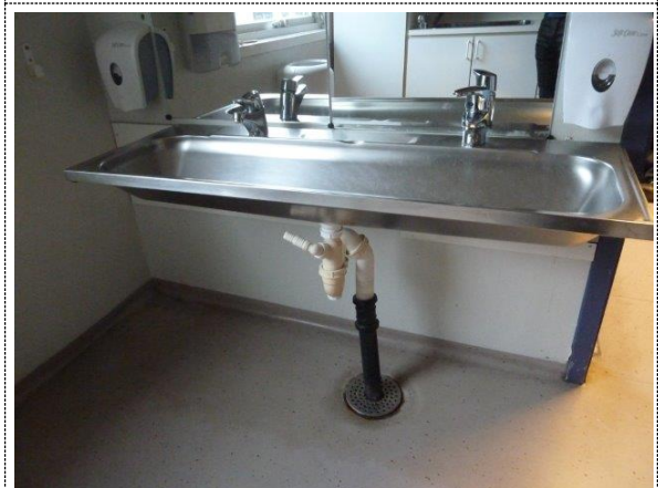
Bilde nr. 310.08 Vaskerenne med stengeventil på avløp.
