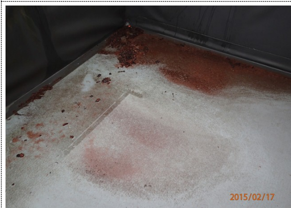
Bilde nr. 280.05 Trapper, balkonger mm. Oppsamling av vann på motsatt side av sluk.
