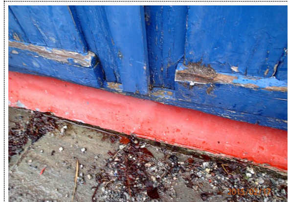
Bilde nr. 234.06 Utvendige vinduer og dører Slitasje på ytterdør.
