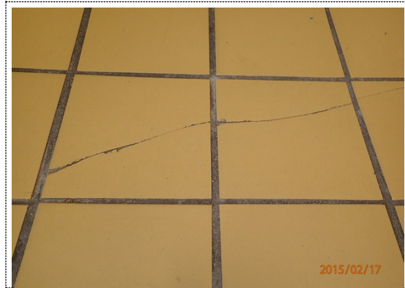
Bilde nr. 255.04 Gulvoverflater Sprekk i fliser på gulv i stellerrom.
