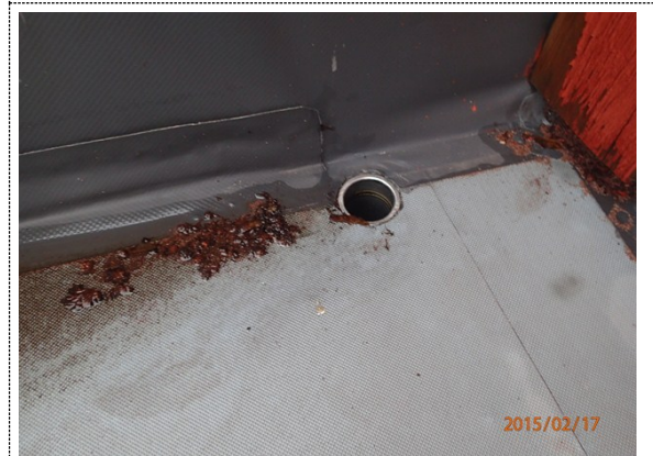
Bilde nr. 280.06 Trapper, balkonger mm. Sluk er på det høyeste punkt av balkong.
