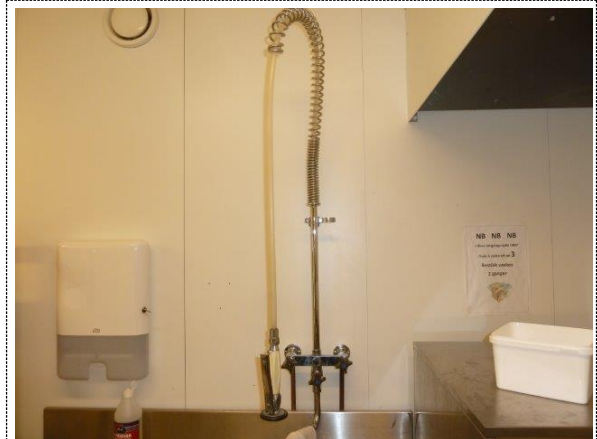
Bilde nr.310.12 Spyle kran med fleksibel slange til dampvasker.
