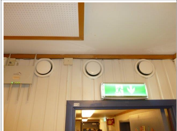
Bilde nr.360.11 Avtrekksventiler.
