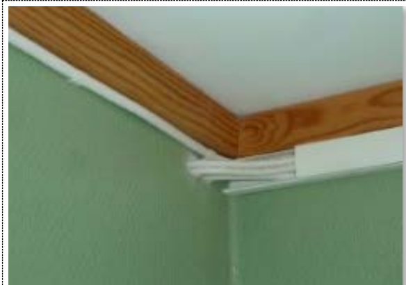
Bilde nr.430.04 Åpen forlegning, dekklokk mangler delvis
