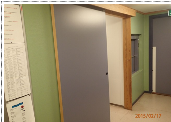
Bilde nr. 244.03 Innvendige vinduer og dører Skyvedør inn til kjøkken 104. Overflate i god stand. Dør defekt ved oppheng. Må justeres.
