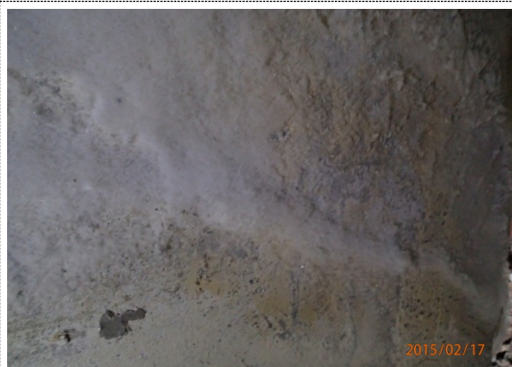
Bilde nr. 210.03 Grunn og fundamenter Tydelig saltutslag på grunnmur.
