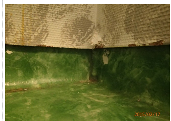
Bilde nr. 240.04 Innervegger Slitasje og småskader på overflater på innervegger på bad.
