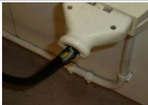
Bilde nr.430.03 Tilkobling ikke forskriftsmessig
