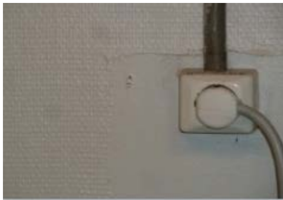
Bilde nr.430.05 Stikkontakt på vegg
