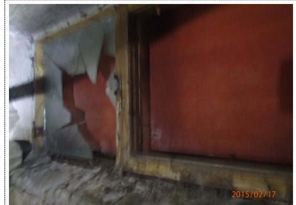
Bilde nr. 210.02 Grunn og fundamenter Innside grunnmur. Rom i kjeller. Spor etter mye fuktighet innside grunnmur.
