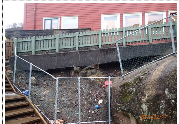
Bilde nr. 721.02 Støttemurer og andre murer. Gangvei ned mot lekearealer på nedsiden av barnehagen. Masser under støttemur for gangvei undergraves.
