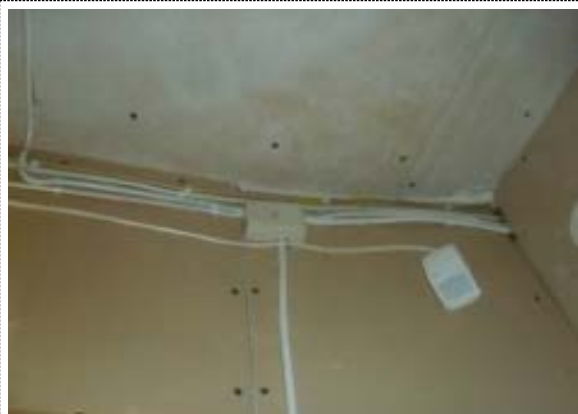
Bilde nr.430.11 På vegg montasje ikke håndverksmessig utført
