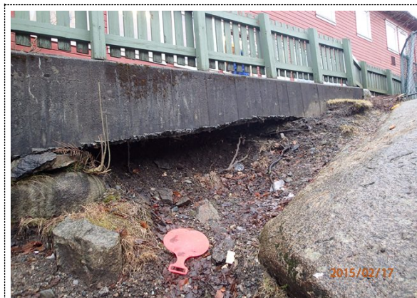
Bilde nr. 721.04 Støttemurer og andre murer. Masser under støttemur for gangvei undergraves.
