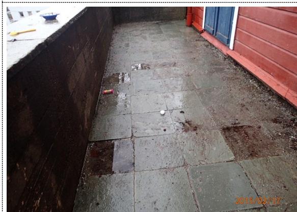
Bilde nr. 760.02 Veier og plasser Terrasse ved utgang fra personalrom 105. Vannansamling og en del løsnet skifer. Terrasse anlagt mot støttemur som har setningskader. Ref. Førrige bilde.
