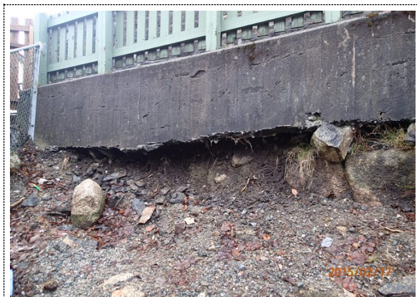
Bilde nr. 721.03 Støttemurer og andre murer. Masser under støttemur for gangvei undergravd.
