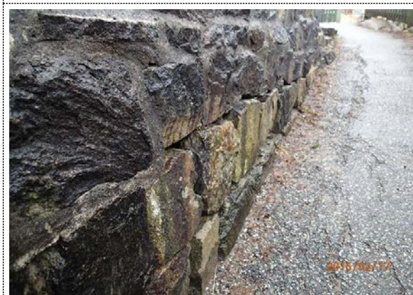
Bilde nr. 721.06 Støttemurer og andre murer. Tydelig setningskade i mur.
