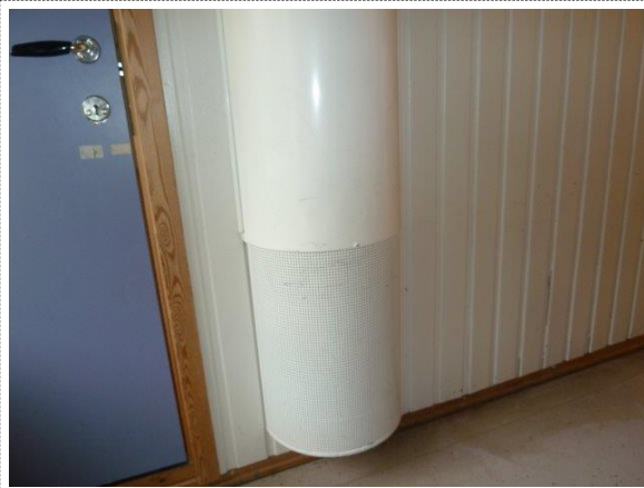
Bilde nr.360.11 Tilluftsdon i hele bygget.
