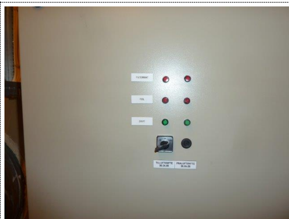
Bilde nr.360.05 Tabule for ventilasjonsaggregat.
