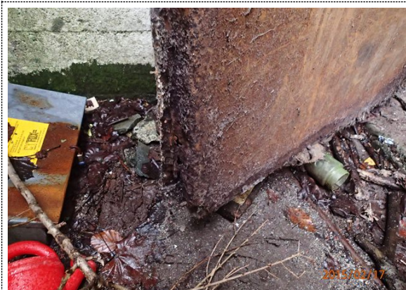
Bilde nr. 234.05 Utvendige vinduer og dører Ytterdør inn til kjeller. Ståldør rustet og sterkt nedslitt.
