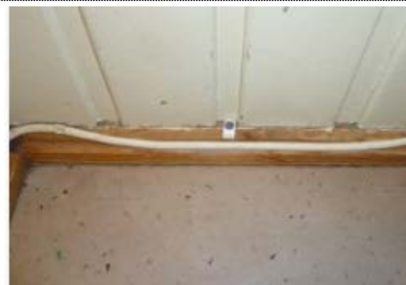
Bilde nr.430.09 Kabel mangler feste
