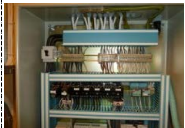
Bilde nr.430.14 Tavle for ventilasjonsanlegg.
