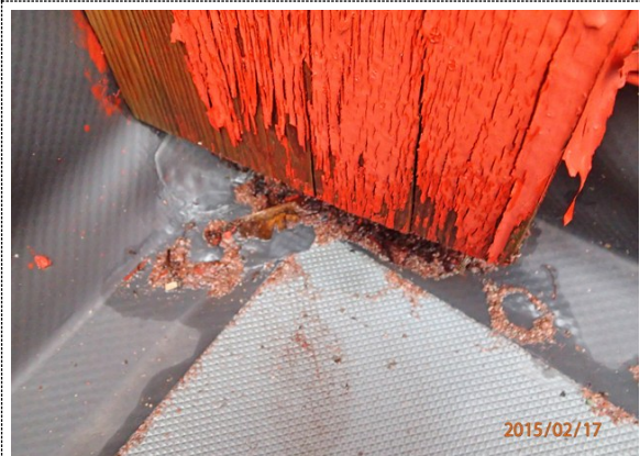
Bilde nr. 230.04 Yttervegger Råteskade på hjørnekjøl.
