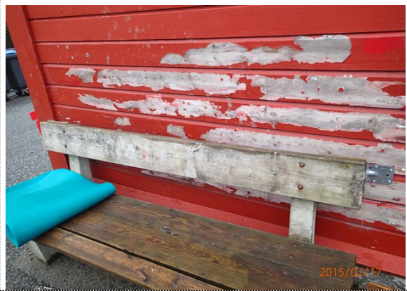
Bilde nr. 230.01 Yttervegger Yttervegger består av dobbel falset liggende kledning. Vegger er malingsslitt. En del råteskadet kledning. Yttervegger med 4` bærende stender.
