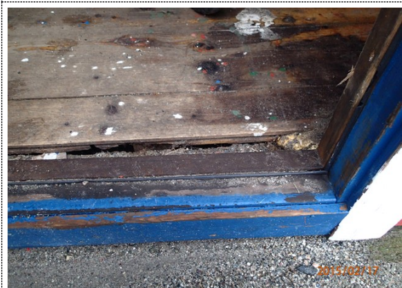
Bilde nr. 720.03 Utendørs konstruksjoner Gulv inne i bod festet på lekter so ligger rett på terreng. Fører til mye fukt og råteskade.
