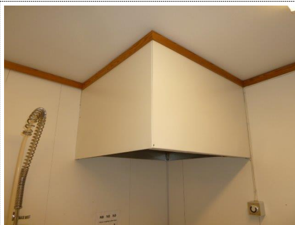
Bilde nr.360.11 Avtrekshette over dampvasker.
