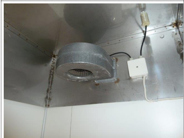
Bilde nr.360.12 Avtrekksvifte i hette til dampvasker..
