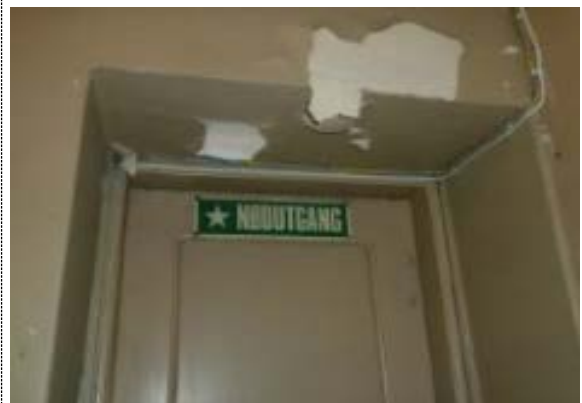
Bilde nr.443.02 Nødlis etterlysende ved utgang i trappeløp
