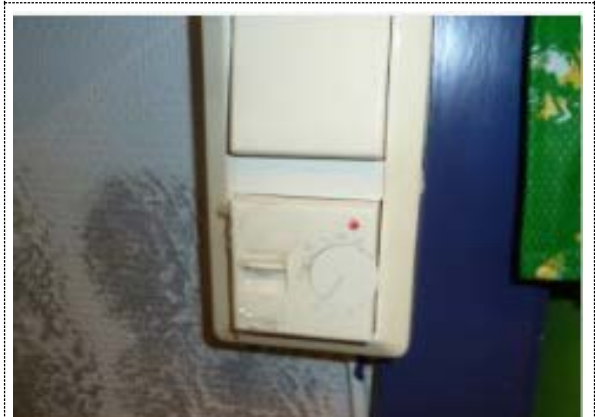
Bilde nr.450.04 Styring varmekabel
