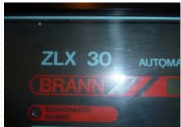
Bilde nr.543.01 Brannalarmsentral
