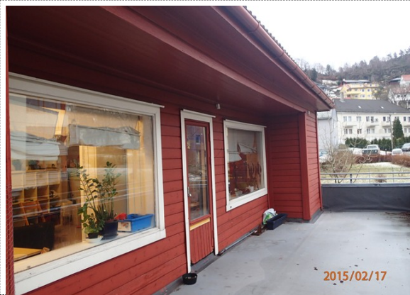
Bilde nr. 250.01 Dekker Balkong / terrasse i 2. etg. betongdekke med tekking på overflate.
