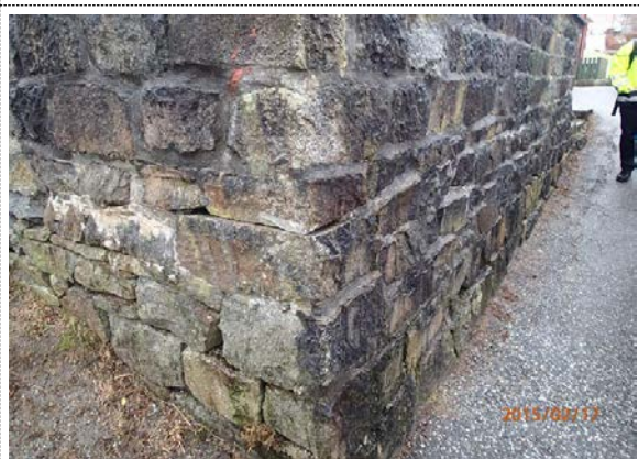
Bilde nr. 721.05 Støttemurer og andre murer. Støttemur på oversiden av gangvei har setningskader. Kan sees i sammenheng med undergraving av masser. Ref. Førrige bilde.
