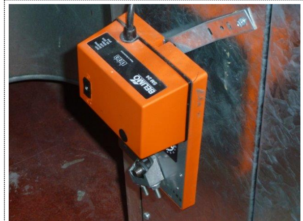
Bilde nr.360.02 Reguleringsspjeld på ventilasjonsanlegg
