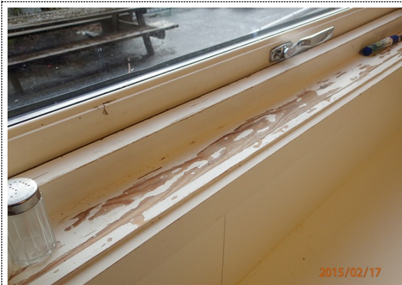
Bilde nr. 234.01 Utvendige vinduer og dører Vinduer består av både åpningsvinduer og faste vinduer. Vinduer preger preg av slitasje.
