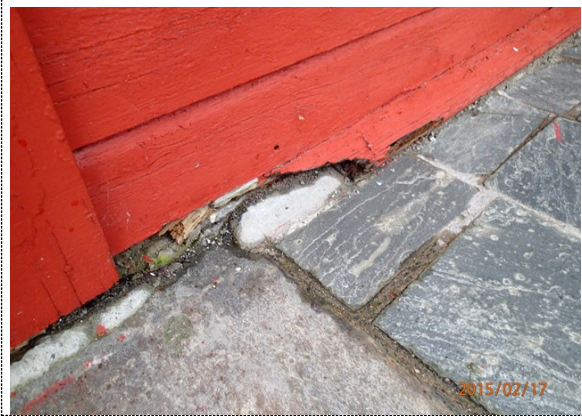
Bilde nr. 230.02 Yttervegger Noe råteskadet kledning. Generelt er yttervegger preget av alder og slitasje.
