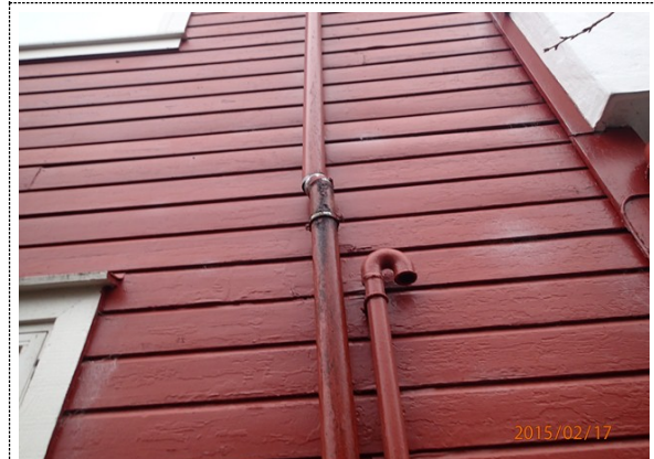
Bilde nr. 265.02 Gesimser, takrenner og nedløp Behov for justering av nedløp.
