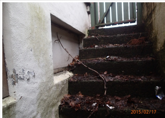
Bilde nr. 210.01 Grunn og fundamenter Grunnmur stort sett synlig kun fra byggets fasade mot vest. En del avskalling av maling på utside. Mye fuktighet som trenger inn på innsiden
