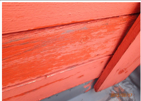
Bilde nr. 230.03 Yttervegger Tydelig slitasje på yttervegg.
