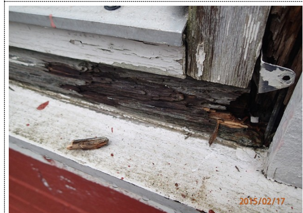
Bilde nr. 234.04 Utvendige vinduer og dører Råteskadet vindu. Noen av gamle vinduskarmen har fått innsatt nytt glass.
