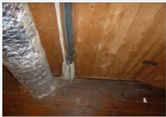
Bilde nr.430.13 Føringsveier til loft og ventilasjonsaggregat
