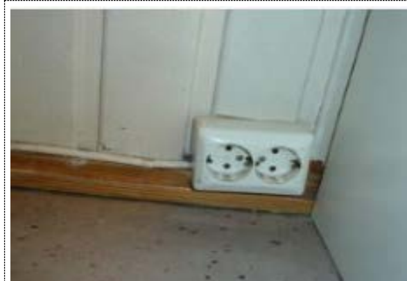
Bilde nr.430.10 Stikkontakt på vegg.
