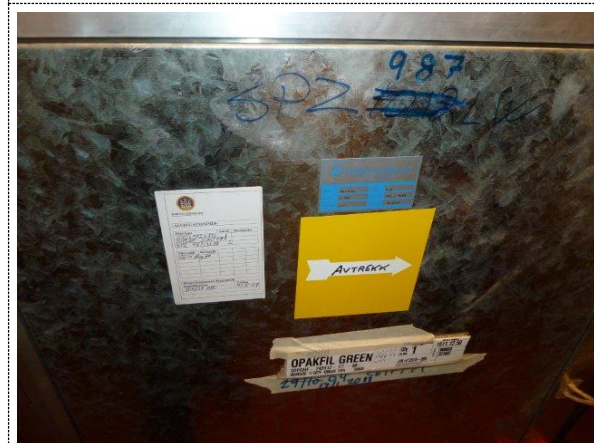
Bilde nr.360.04 Merking på ventilasjonsaggregat.
