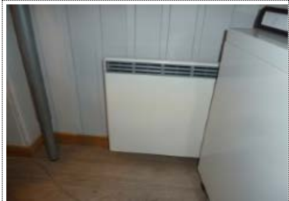
Bilde nr.450.02 Panelovn delvis tildekket
