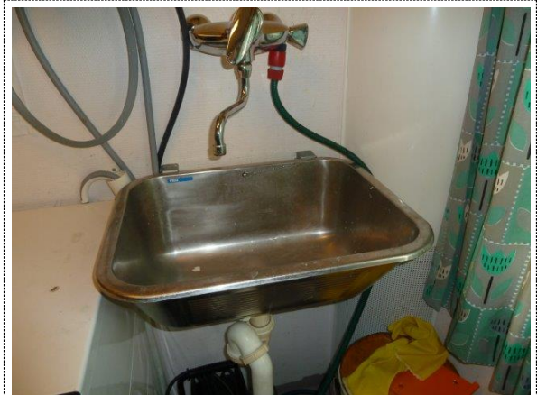
Bilde nr. 310.06 Utslagsvask i vaskerom.
