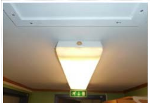
Bilde nr.440.02 Belysning i korridor
