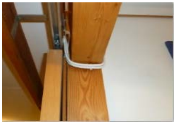
Bilde nr.430.07 Kabel forlagt gjennom skyvedør til kjøkken
