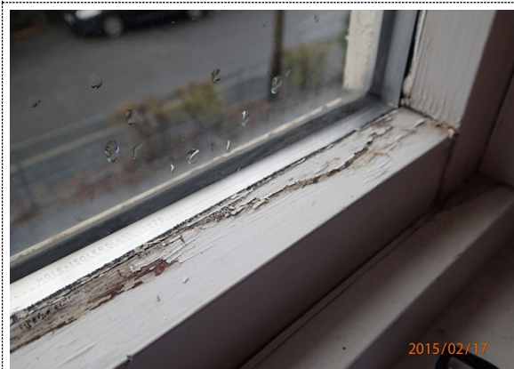
Bilde nr. 234.03 Utvendige vinduer og dører En god del slitasje på vinduer.
