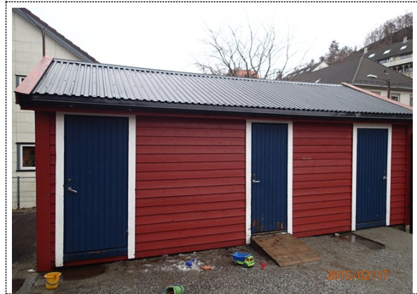
Bilde nr. 720.02 Utendørs konstruksjoner Bod for oppbevaring av leker. Vannansamling foran dører.
