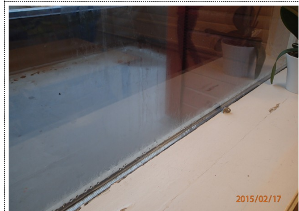
Bilde nr. 234.02 Utvendige vinduer og dører Vindu med fast felt. Rute er punktert.
