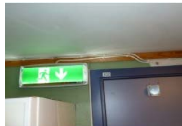
Bilde nr.430.08 Åpen forlegning ikke pent utført
