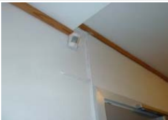
Bilde nr.540.01 Innbruddsalarm detektor
