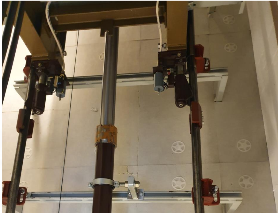
2.01.6 Stempel – Pakninger skiftes og hydraulikk olje byttes. Klakker skal fjernes.
