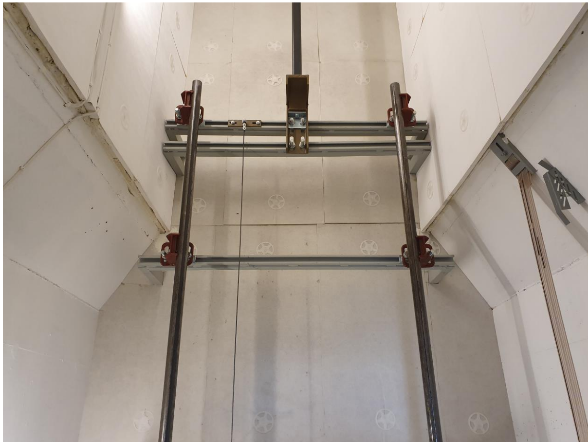
2.01.8 Bilde av sjaketopp. Sjakten har innsnevring i topp av sjakten. Må tas hensyn til.
