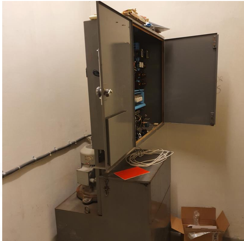
2.01.6 Bilde av maskinrom – Hydraulikk olje må leveres til godkjent deponi.
