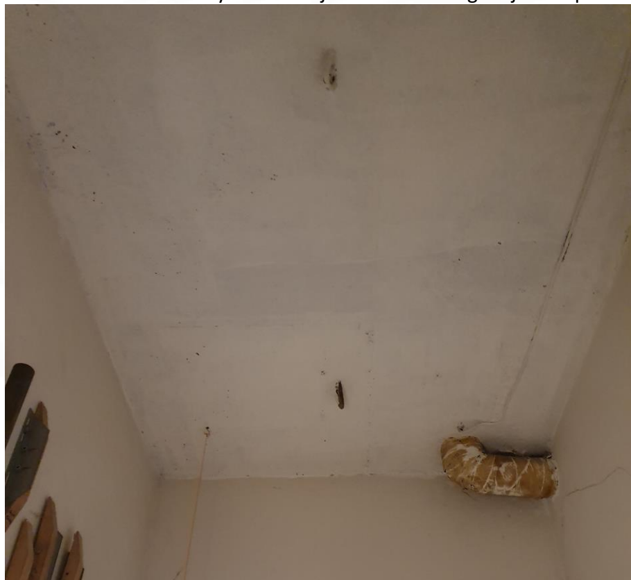
2.01.7 – Bilde av sjakttopp. Ventilasjon er montert lengre nede på vegg.
