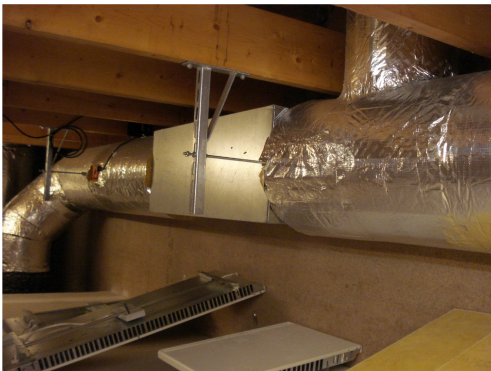
Figur 2. Ventilasjonskanaler på loft som gir varmetilskudd
