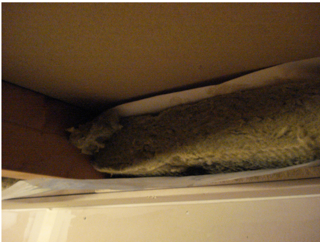
Figur 3. Isolert tak over teknisk rom på loft. Luftespalte begrenset
