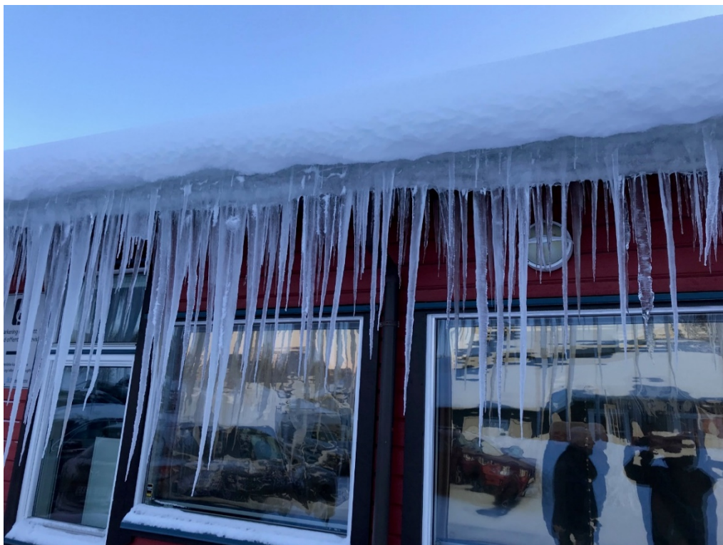
Figur 1. Bildet viser store problemer med istapper på tak
