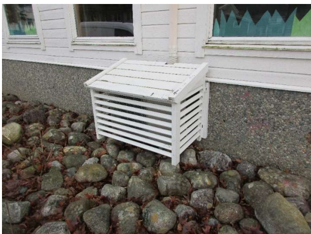
Figur 3: Kjølemaskin på fasade.
