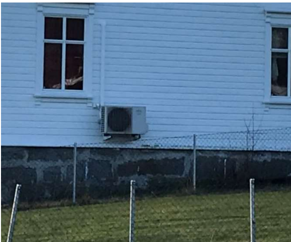
Figur 5. Varmepumpe på fasade.
