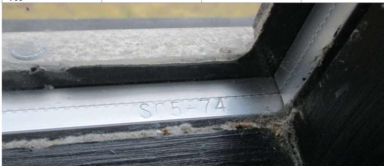
Figur 2: PCB-holdige vinduer i C-bygg.
