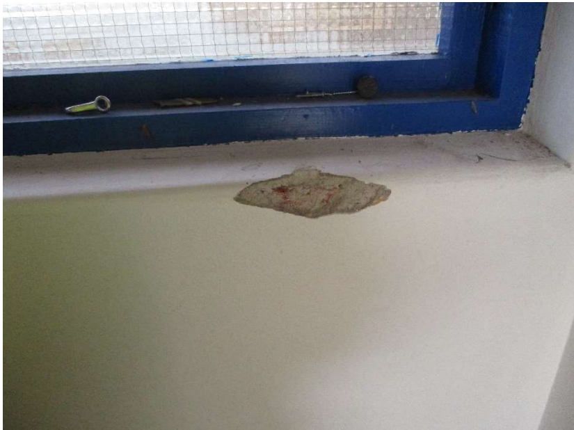
Figur 3: Hvit PCB-holdig maling på innsiden av yttervegg, Bygg F.
