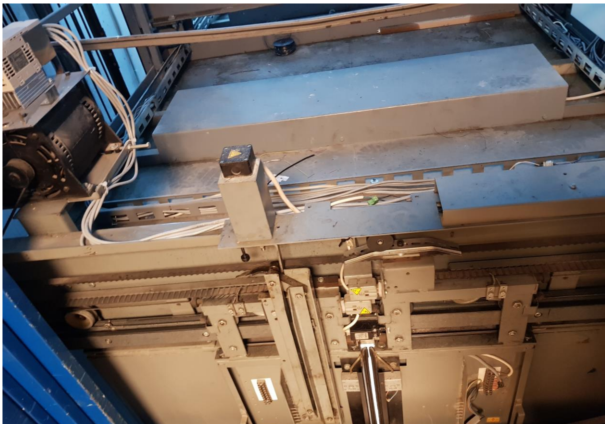
2.01.7 Heistak – alle heistekniske komponenter skal fjernes.
