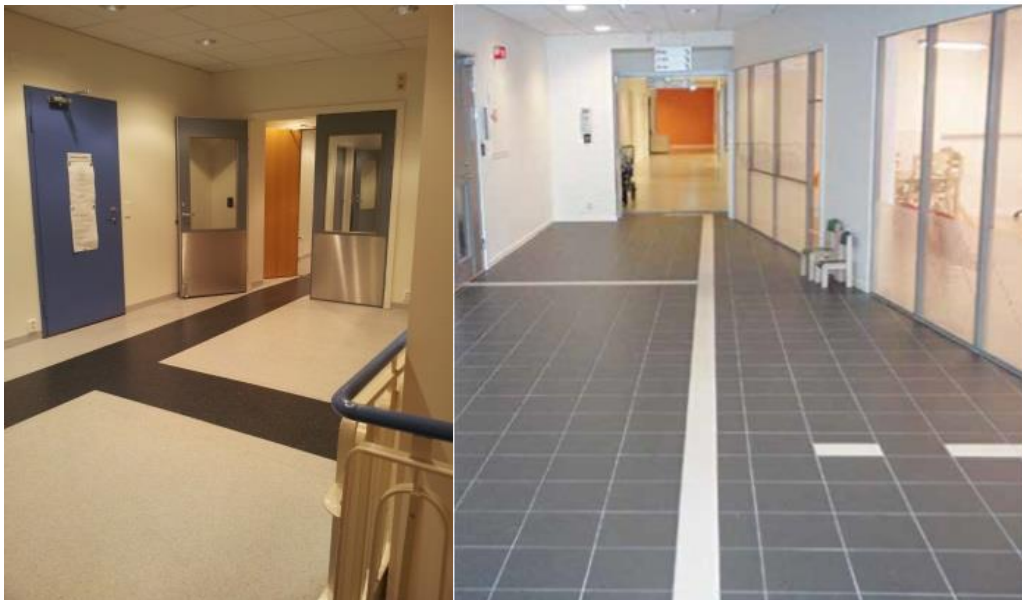
Figur 18 Eksempler på innendørs ledelinjer med kontrast for veifinning (Foto: Ski kommune og Jan Tore Lindskog/Omsorgsbygg Oslo KF)
