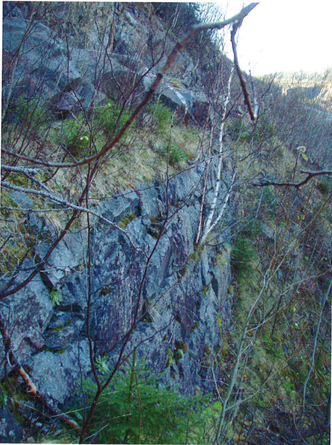
Foto 11: Profil 630-660, Støttemur, bratt. Vegen antas å ligge på en fjellhulle pga høye skjæringer på vegens innside
