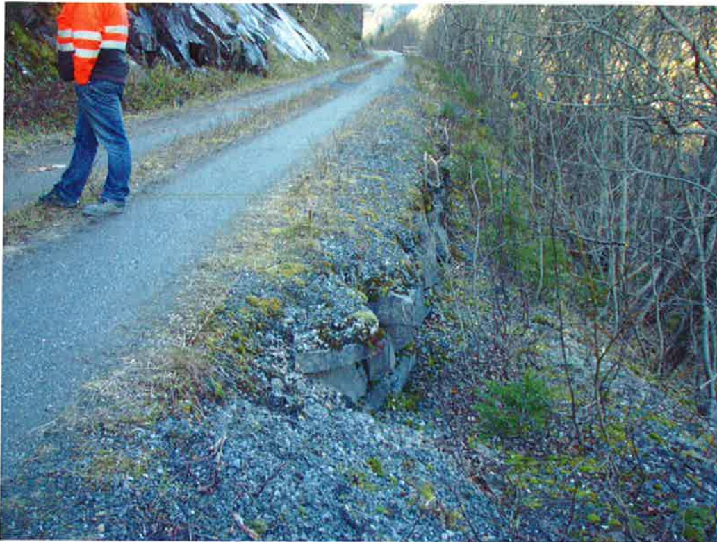
Foto 16: Profil 80-100, Støttemur, sva på vegens overside
