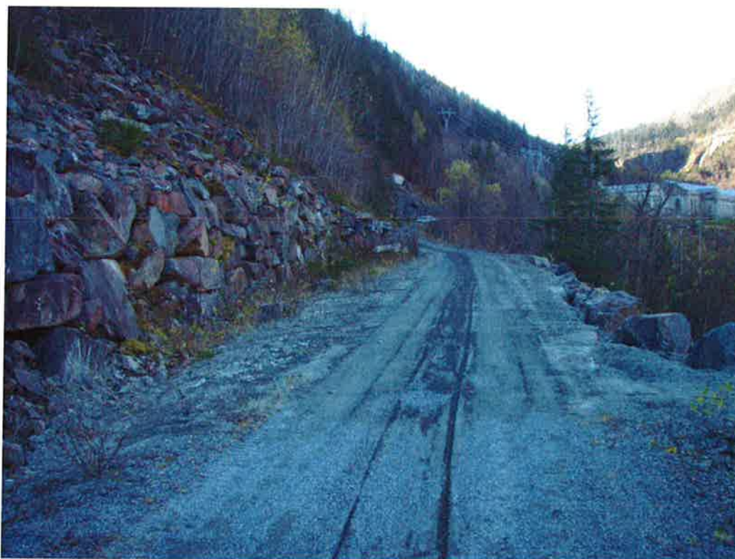
Foto 6: Profil 300-400, vegen utvides i svingen lenger fram, pga utbulning støttemur. Eldre langsgående støttemur med steinplastring ligger langs vegen her
