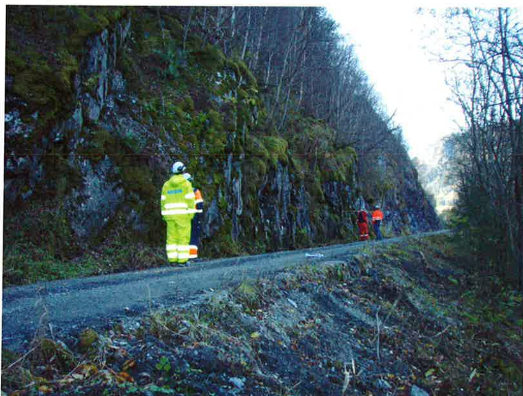
Foto 25: Profil 1000, Fjellnabbe på vegens innside. Eldre støttemur på vegens nedside
