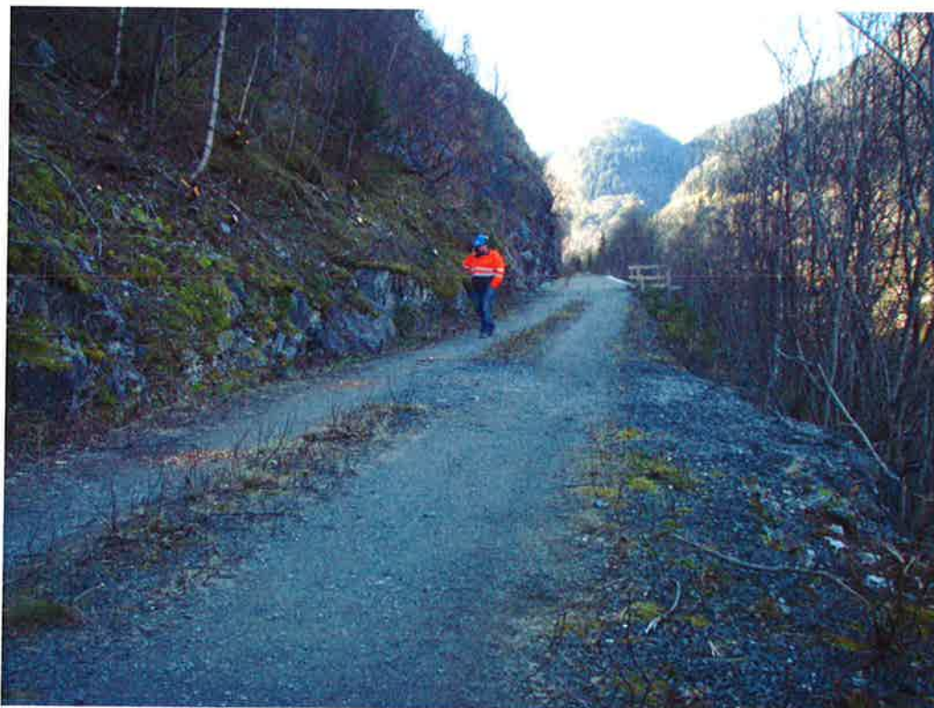
Foto 15: Profil ca. 40, Nedsenkning på vegens ytterside
