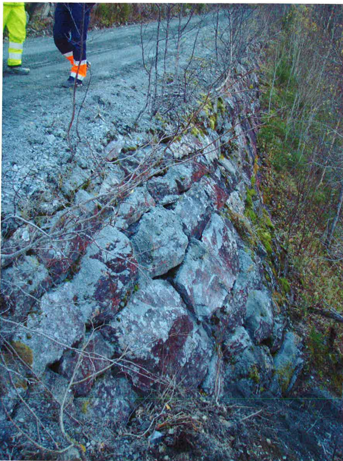
Foto 4: Profil 300-400, Støttemur på vegens nedside, utbulning i nedkant, hult på innsiden
