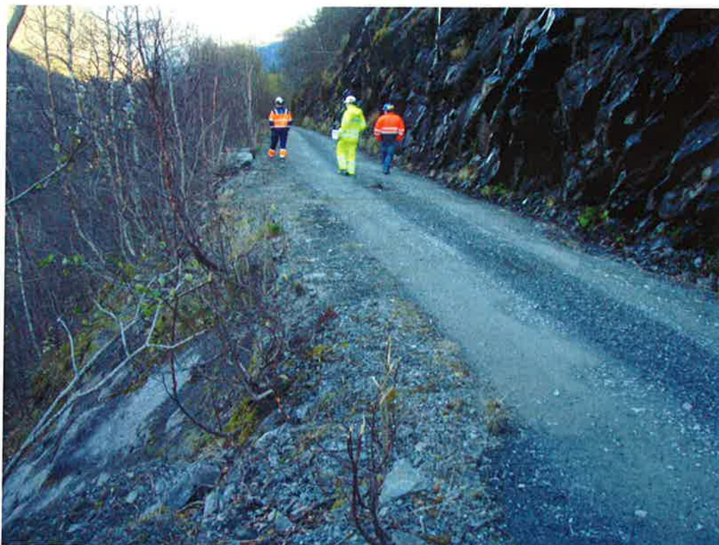
Foto 24: Profil 900, fjell i dagen på vegens nedside. Veggen antas å ligge å en fjellhylle langs hele den høye fjellskjæringa.
