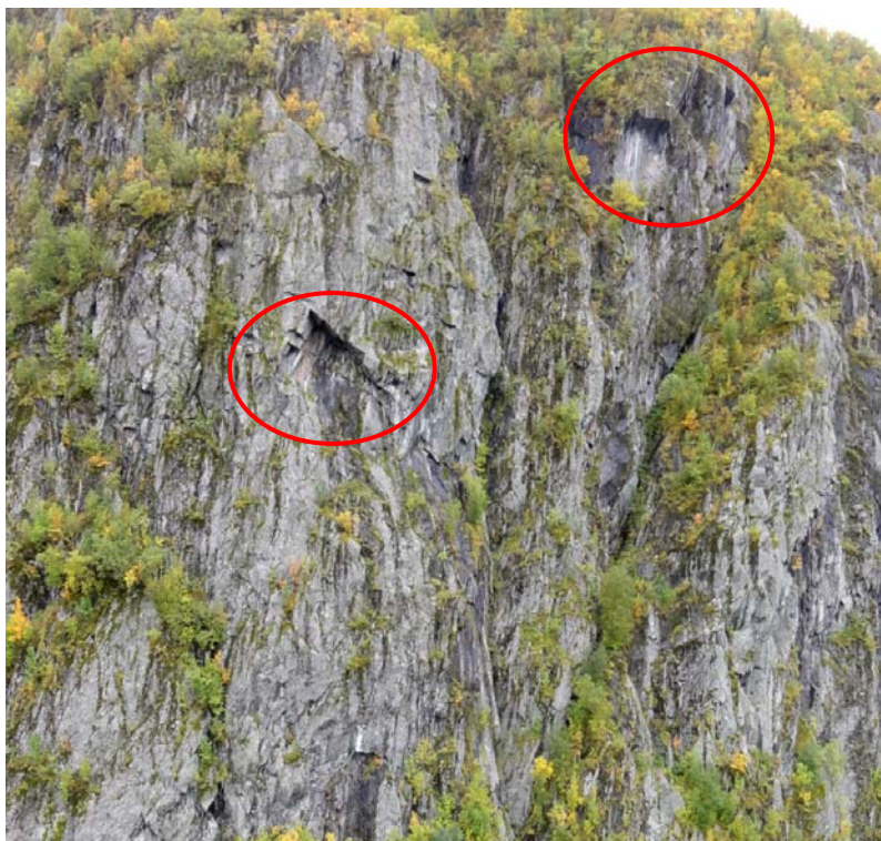
Figur 15: Nærbilde av øvre parti av Klokkshovd. Fjellsiden er her høy og steil med noen markerte overheng hvor partier har løsnet tidligere, og hvor det kan løsne igjen (innringet i rødt). Fjellsiden her er for øvrig ikke sterkt oppsprukket.
