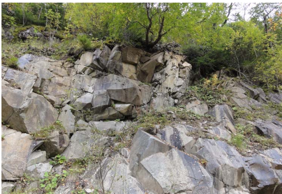
Figur 32: Store deler av veiskjæringen består av løse blokker. Herfra vil blokker kunne løsne og falle ut i veien.
