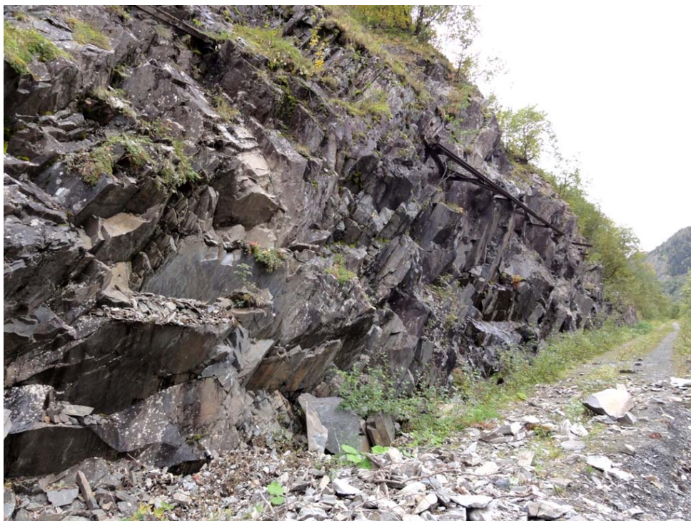
Figur 31: Veiskjæring ved tipp 3, vis a vis Flåten. Berget er meget oppsprukket og flere blokker har løsnet herfra tidligere. Oppsprekking er langs lagflater med bratt fall mot sør (som i figur 30), slik at blokker heller utover mot veien. Dette kan føre til at flak faller ut. Steinspranget som har tatt med seg deler av veien her har løsnet fra høyere opp i fjellsiden (se figur 5).
