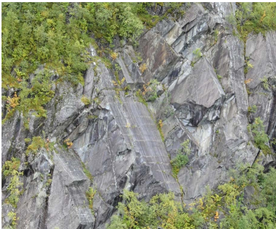
Figur 21: Berget her er oppsprukket på en slik måte at blokker vil kunne løsne og gli ut langs bratte utoverhellende sprekkeplan.
