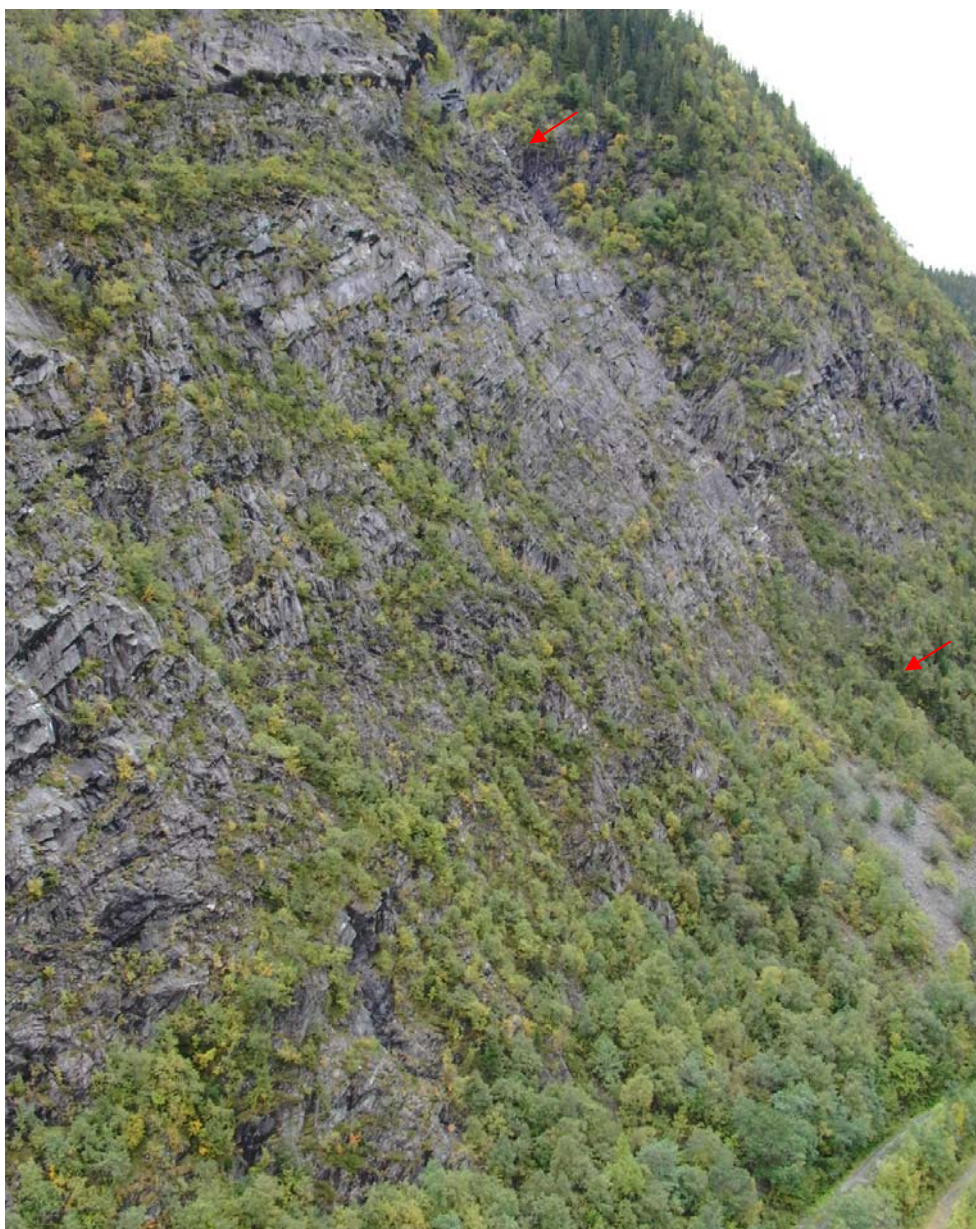
Figur 22: Fjellsiden sett vestover fra tipp 3, vis a vis Flåten. Fjellet her er oppsprukket langs skråstilte lagflater og omtrent vertikale sprekker. I hele området finnes løse blokker og overheng. Harehovdagjelet skjærer fjellsiden og kommer ned som indikert med røde piler.
