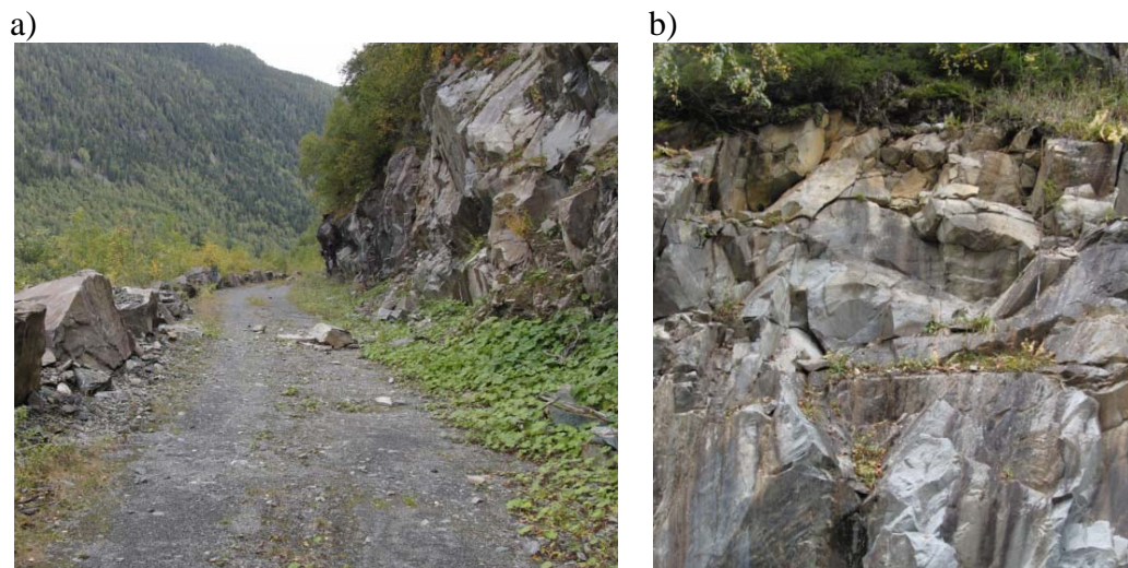
Figur 12: a) Utfallet ses midt i bildet; en mindre steinblokk har nådd veien nærmest Vemork. b) Utløsningsområdet ses øverst i skjæringa; berget er tydelig oppsprukket og flere løse blokker med mulighet for å rase ut ligger igjen.
