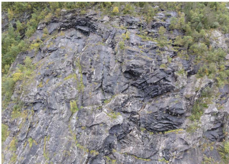
Figur 14: Utpregede sva i fjellsiden over fabrikkområdene med steilt fall utover. Her vil større og mindre partier kunne løsne og gli ut. Det er tydelig av bildet at slike utfall har skjedd flere ganger tidligere.
