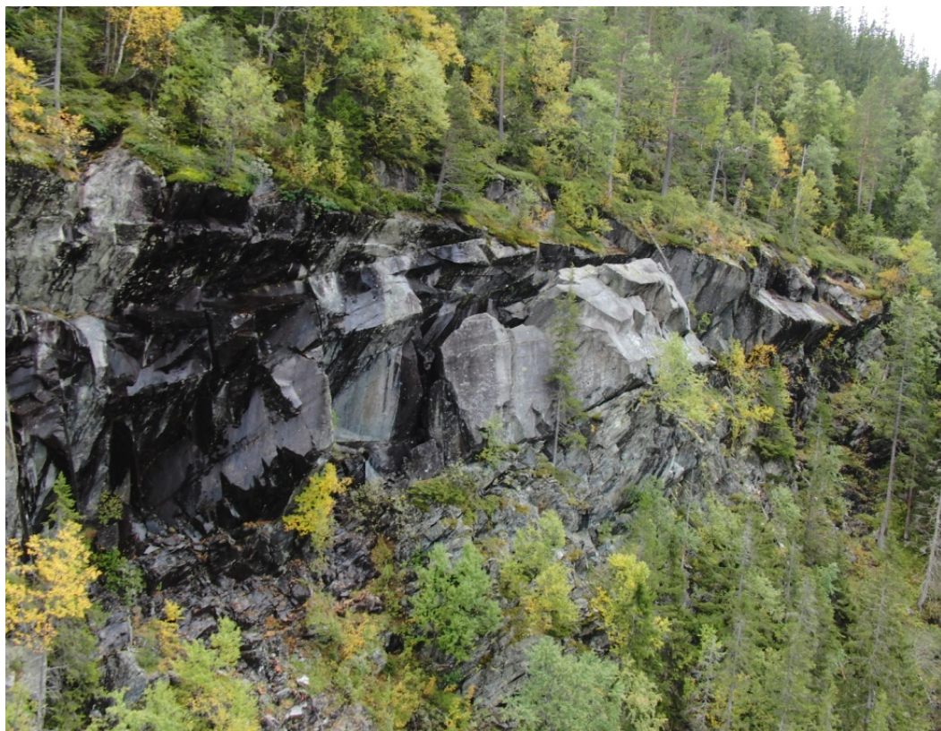
Figur 30: Avløst blokk med en ca. 2 m bred sprekk i bakkant og fot som hindrer den å falle ut i fremkant. Hele dette området er tydelig oppsprukket langs bergartens lagdeling. Partier kan flake av og falle ut i dette området.
