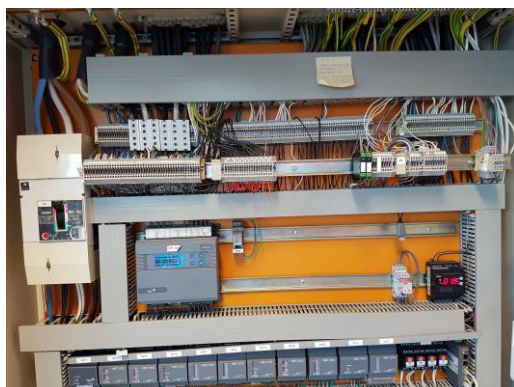
Dagens tavle med Johnson-modul for kommunikasjon med SD-anlegget
