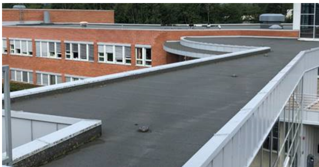
Figur 1.18-2: Overgang mellom bygg B og K. Her skal det monteres rekkverk som fallsikring.
