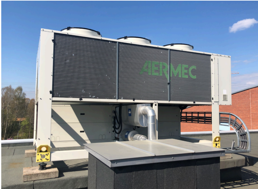
Figur 3.7.0-1: Eksisterende kjølemaskin på tak.
