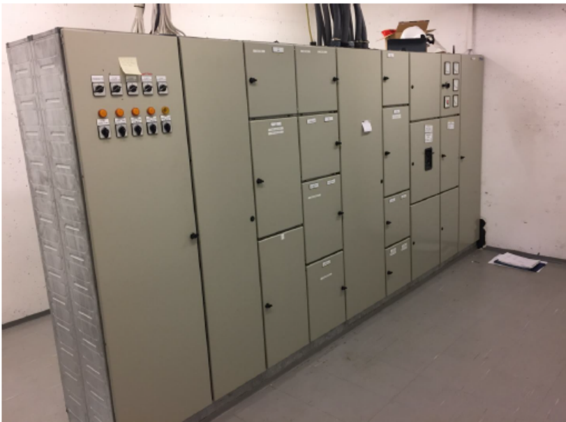
Figur 4.3.2-1: Eksisterende hovedtavle i kjeller, rom B-034.
