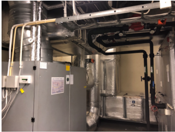
Bilde 3 Ventilasjonsanlegg garderobedel
