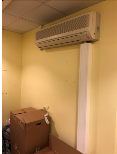
Bilde 2 Kjøleunit korridor ved rom 135
