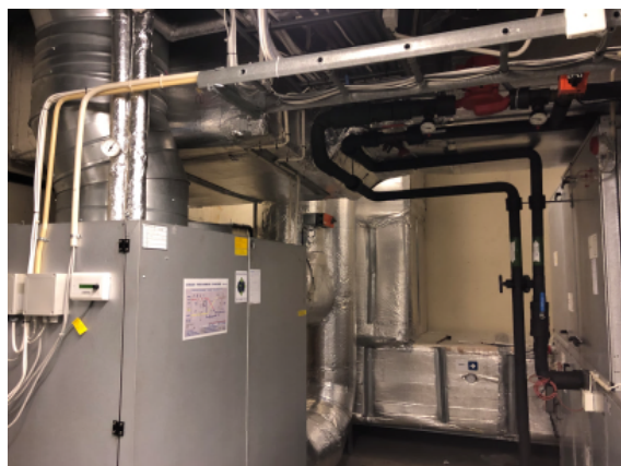
Bilde 3 Ventilasjonsanlegg garderobedelen
