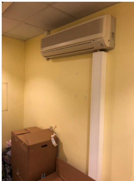
Bilde 2 Kjøleunit korridor ved rom 135
