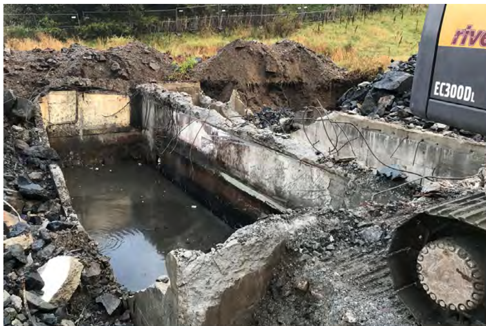
Figur 4.6: De to rommene med oljeholdig vann som lå under gulvdekket i vaskehallen. Bildet er tatt mot nord.
