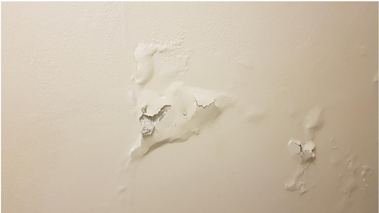
Bilde nr. 2-Tegn på fuktgjennomslag.
