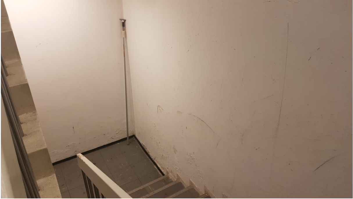
Bilde nr. 3- Trappeoppganger fra kjeller. Det er tegn på fuktgjennomslag.
