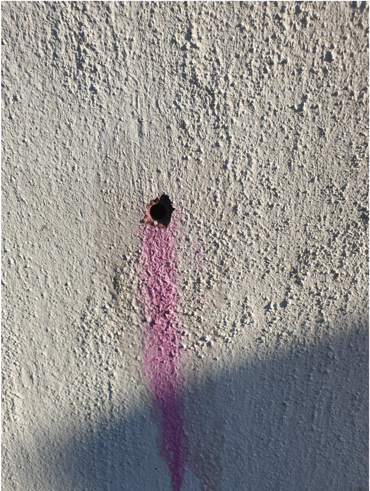
Bilde nr. 8 – Nærbilde karbonatiseringsdybde.
