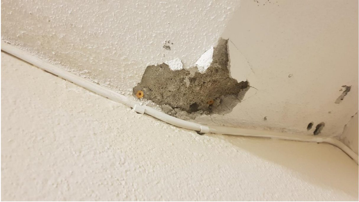
Bilde nr. 7- Løs murpuss etter boring, innvendig trappeoppgang.
