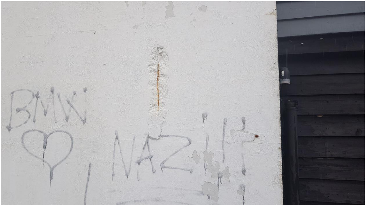
Bilde nr. 4- Gavlvegg med synlig armering etter rustsprengning i akse G-4.
