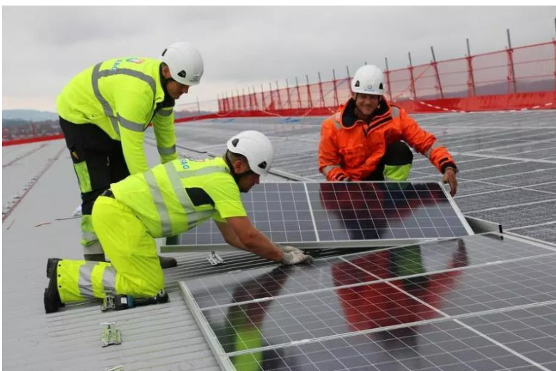
Figur 9 Solcellepaneler montert på blikkplate tak. Bilde: Skagerak energi.
