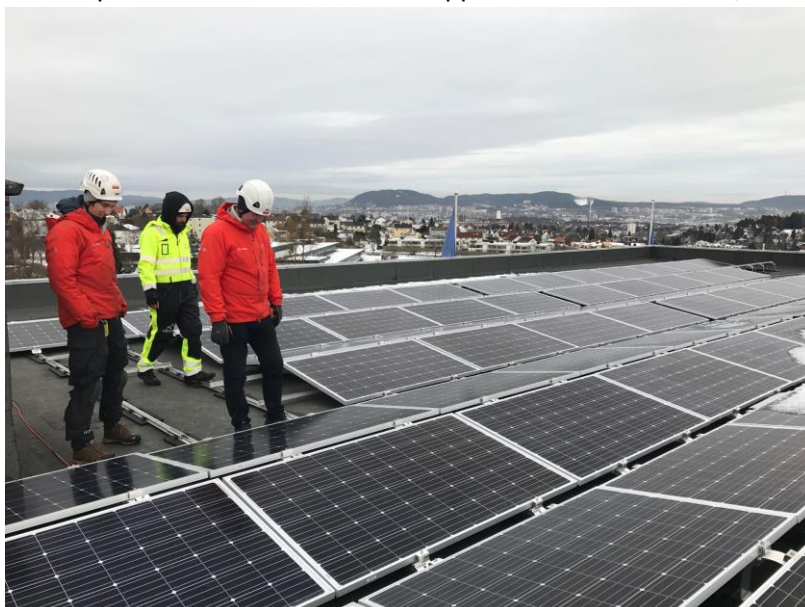
Figur 7 Typisk øst/vest installasjon på et tak i Oslo. Bilde: Multiconsult.
