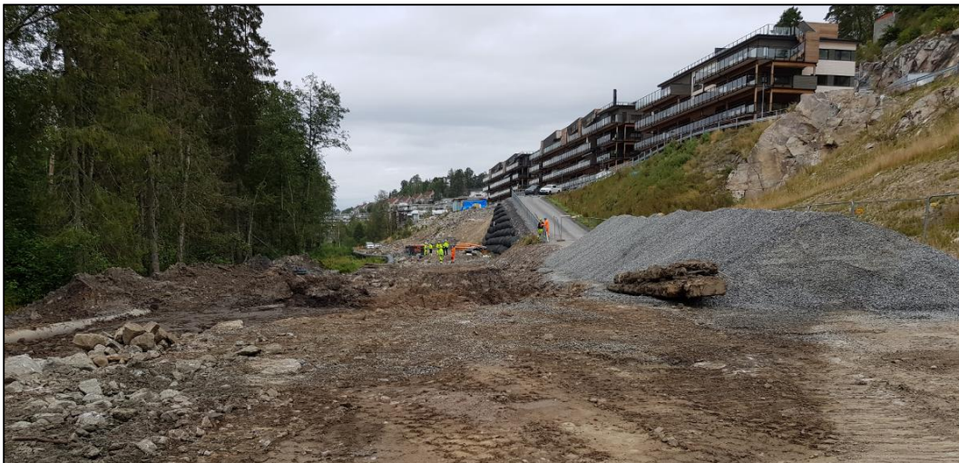
Figur 13. Foto fra området ved Dalsbekken/Kongslia der tunnelportalen skal bygges og spillvannsledningen fra Vevelstad skal kobles på hovedspillvannsledningen Ski-Haugbro. Foto Sweco august 2019.
