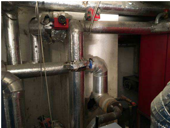
Foto 31: Varmesentral i kjeller bygg C
