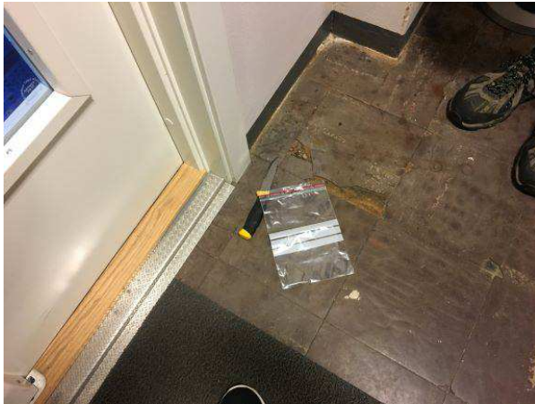
Foto 35: Prøve nr 1 - gulvbelegg. Påvist asbest.
