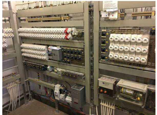
Foto 32: El.tavle i sokkel bygg D
