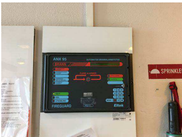
Foto 33: Brannalarmsentral i bygg D
