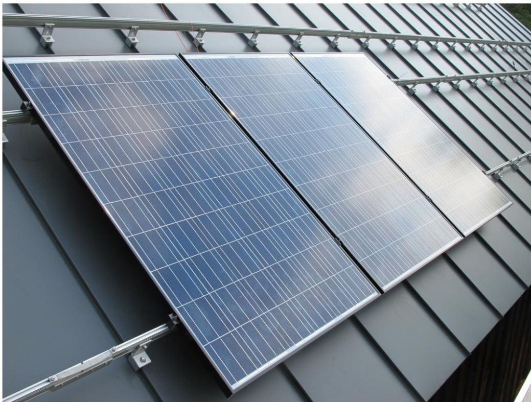
Figur 4: Bygningsadaptert solcelleanlegg på ståltak.
