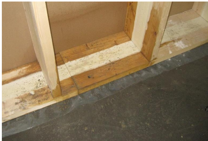
Figur 4-1: Eksempel på oppfuktet bunnsvill og vindsperre
