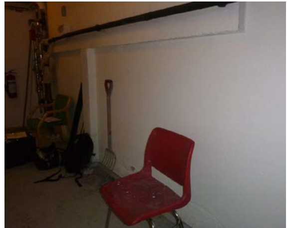
Figur 11 Hvitmaling på vegg i kjeller (TF11).
