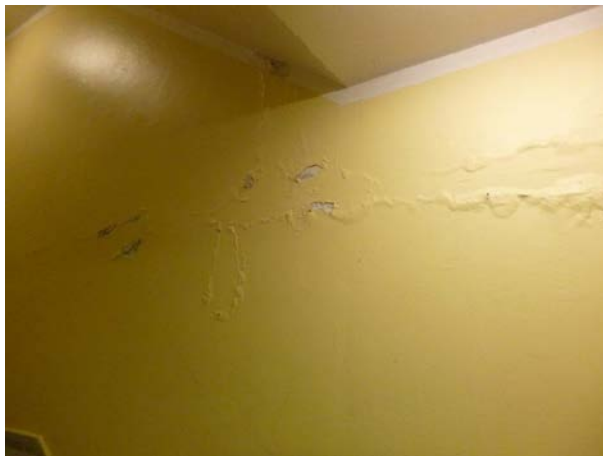
Figur 12 Gulmaling på vegg i trappeoppgang (TF23).
