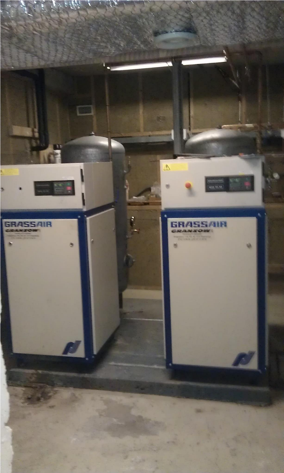
Bilde av eksisterende kompressorenheter med trykktanker
