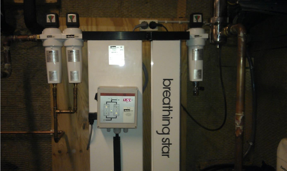
Bilde av eksisterende kombinerte filter- og tørkearrangement 1
