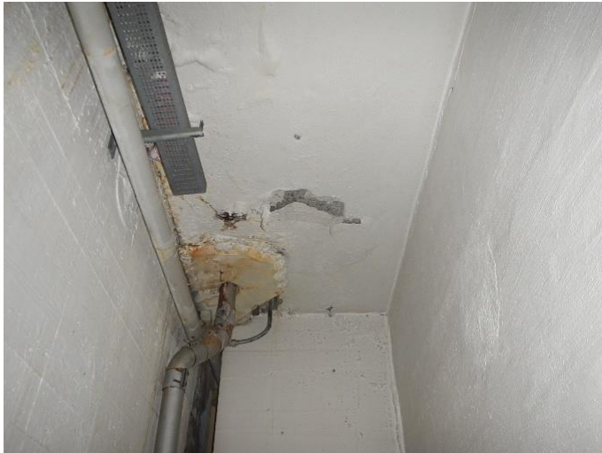
Bilde 1: Bomskaade i underkant dekke i kjeller
