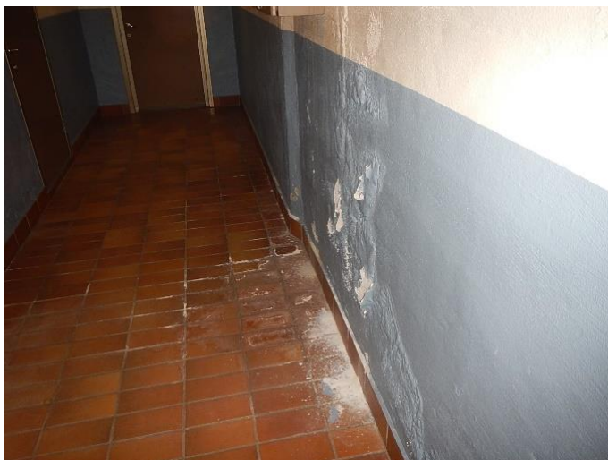
Bilde 3: Fuktskader med saltutslag på innvendig kjellervegg
