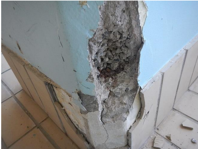
Bilde 7: Avskalling på søyle i bassengdel viser steinreir og armeringskorrosjon
