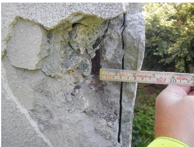
Bilde 6: Hjørneavskalling på veggsøyle viser delaminert pusslag, steinreir og armeringskorrosjon
