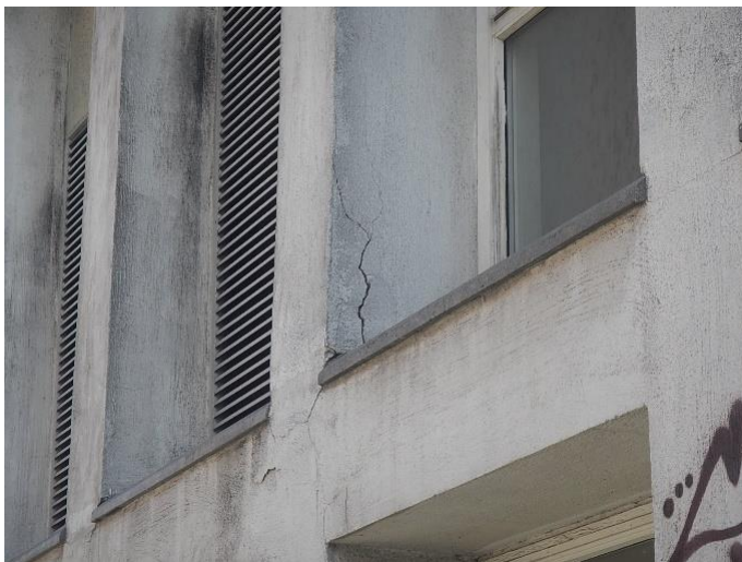
Bilde 5: Riss og sprekker i tilknytning til veggsøyle rundt vindu
