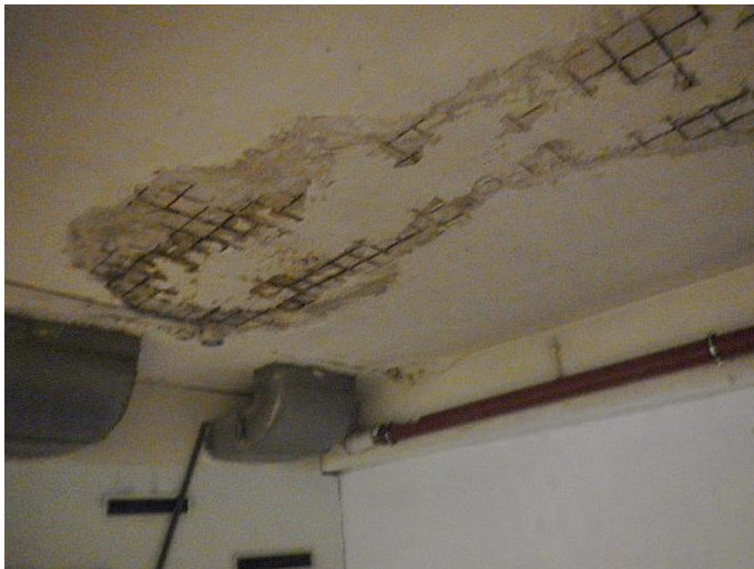
Bilde 8: Frilagt armering i fuktskadet område med lav overdekning, i underkant av dekke i kjeller
