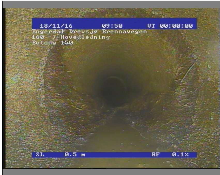
Foto: 21_21_228_A.JPG 0,7m, Røtter, reduksjon i tverrsnittsarealet 15% Reduksjon , fra 3 til 9 Kl., sammenfiltrede røtter / rottugge
