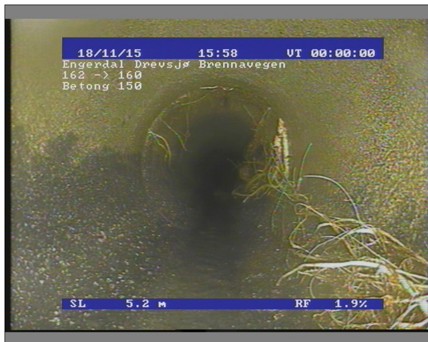
Foto: 18_18_188_A.JPG 5,2m, Røtter, reduksjon i tverrsnittsarealet 3% Reduksjon, fra 2 til 6 Kl., enkelte fine rottråder
