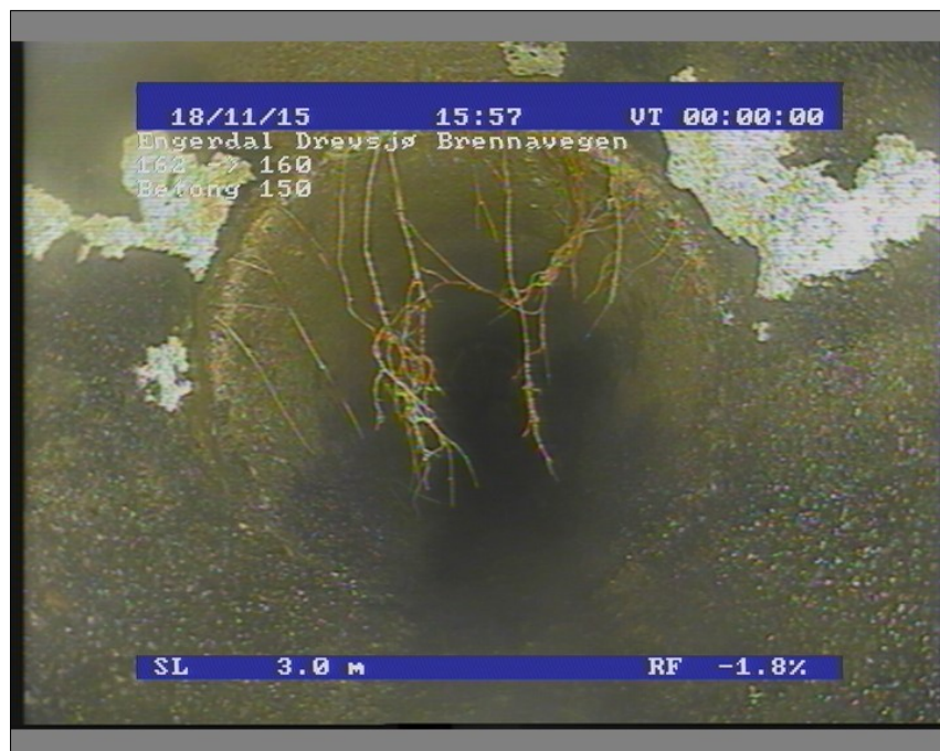
Foto: 18_18_186_A.JPG 3,1m, Røtter, reduksjon i tverrsnittsarealet 3% Reduksjon, fra 10 til 2 Kl., enkelte fine rottråder
