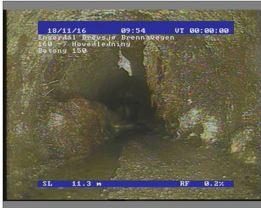
Foto: 21_21_234_A.JPG 11,5m, Røtter, reduksjon i tverrsnittsarealet 20% Reduksjon , fra 12 til 6 Kl., sammenfiltrede røtter / rottugge
