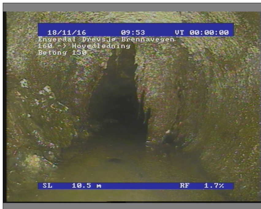
Foto: 21_21_232_A.JPG 10,6m, Røtter, reduksjon i tverrsnittsarealet 20% Reduksjon , fra 11 til 5 Kl., sammenfiltrede røtter / rottugge
