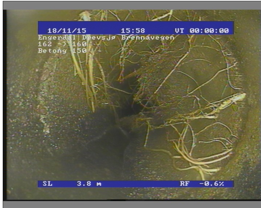
Foto: 18_18_187_A.JPG 3,8m, Røtter, reduksjon i tverrsnittsarealet 20% Reduksjon, fra 8 til 4 Kl., tykk rotgren
