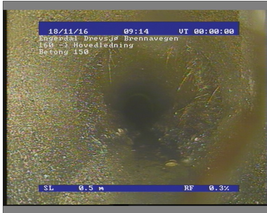
Foto: 20_20_219_A.JPG 0,7m, Røtter, reduksjon i tverrsnittsarealet 20% Reduksjon , fra 3 til 9 Kl., sammenfiltrede røtter / rottugge
