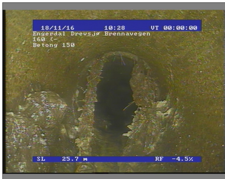
Foto: 23_23_247_A.JPG 25,8m, Røtter, reduksjon i tverrsnittsarealet 30% Reduksjon , fra 8 til 4 Kl., sammenfiltrede røtter / rottugge
