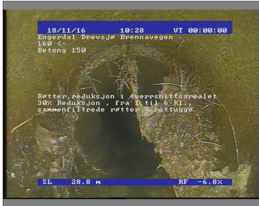
Foto: 23_23_248_A.JPG 28,8m, Røtter, reduksjon i tverrsnittsarealet 30% Reduksjon , fra 1 til 6 Kl., sammenfiltrede røtter / rottugge
