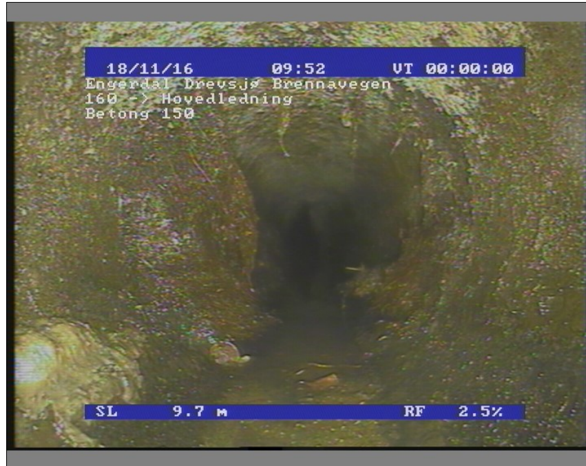
Foto: 21_21_230_A.JPG 9,8m, Røtter, reduksjon i tverrsnittsarealet 20% Reduksjon , fra 2 til 10 Kl., sammenfiltrede røtter / rottugge
