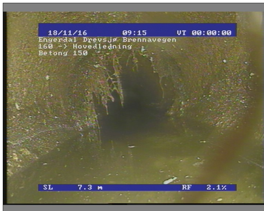
Foto: 20_20_220_A.JPG 7,5m, Røtter, reduksjon i tverrsnittsarealet 10% Reduksjon, fra 9 til 3 Kl., enkelte fine rottråder
