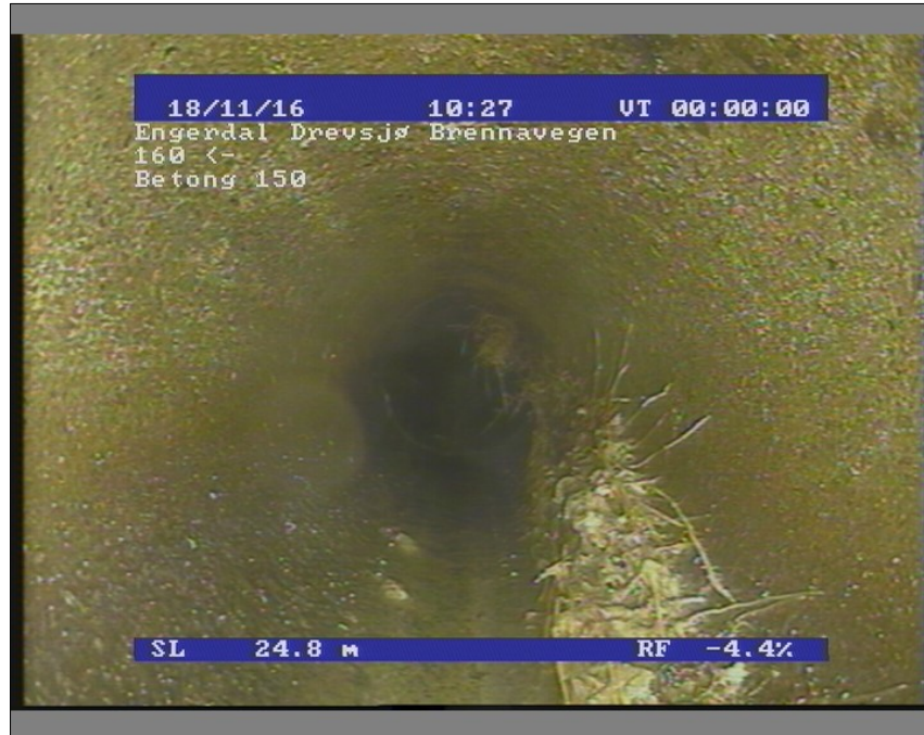
Foto: 23_23_246_A.JPG 24,9m, Røtter, reduksjon i tverrsnittsarealet 10% Reduksjon , fra 2 til 6 Kl., sammenfiltrede røtter / rottugge
