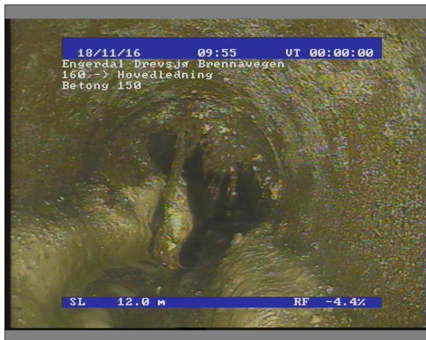
Foto: 21_21_235_A.JPG 12,1m, Utfelling/Belegg, reduksjon i tverrsnittsarealet 30% Reduksjon, fra 3 til 9 Kl., fett
