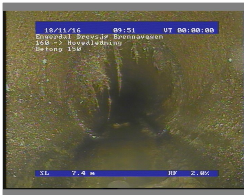
Foto: 21_21_229_A.JPG 7,5m, Røtter, reduksjon i tverrsnittsarealet 10% Reduksjon, fra 9 til 3 Kl., enkelte fine rottråder
