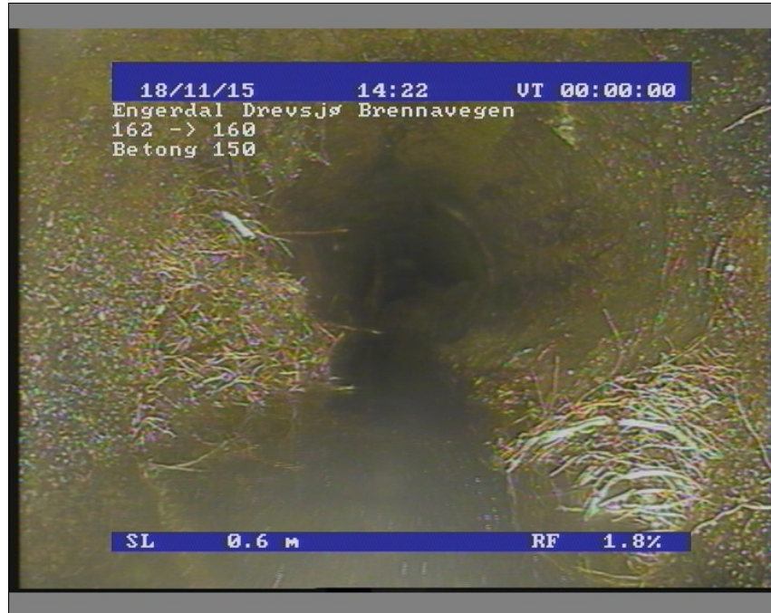
Foto: 16_16_168_A.JPG 0,6m, Røtter, reduksjon i tverrsnittsarealet 15% Reduksjon , fra 3 til 9 Kl., sammenfiltrede røtter / rottugge
