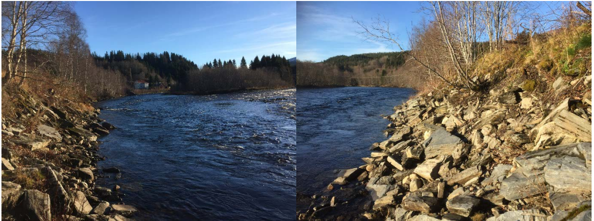
Figur 4: 4121 – Helgåa ved Åkerenget. Sikringstiltaket er i dag preget av manglende låsing av større stein som ligger ustabil i skrånningen.
