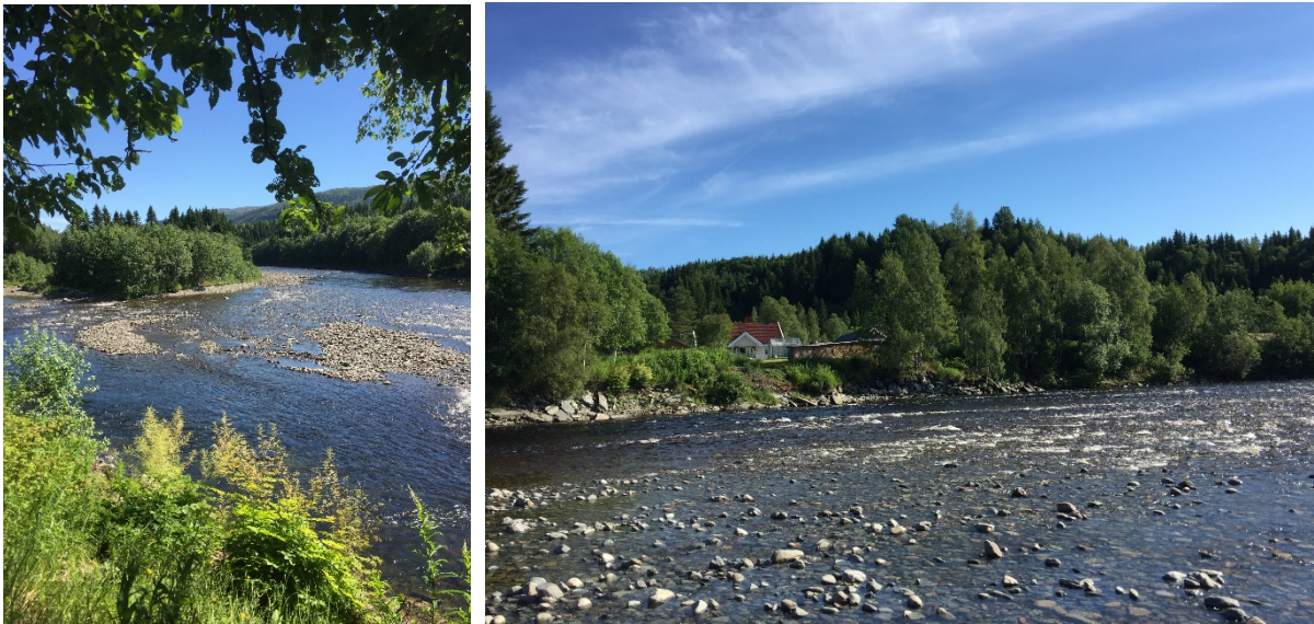
Figur 6: Sikringstiltaket i Helgås ved Åkerenget. Venstre bilde viser hvordan hovedstrømmen fra Helgås styres direkte mot sikringstiltaket. Høyre bilde viser tilstanden til sikringstiltaket i dag, der stein er rast ut og sikringstiltaket står i bratt helning ut mot elva.
