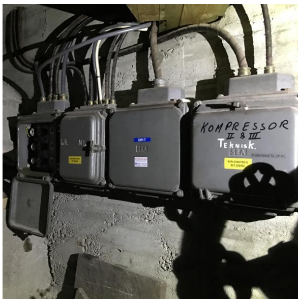
Eksisterende tavler Tunell
