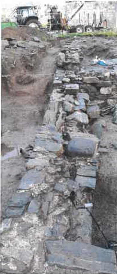
Figur 2: Ustabil vestmur i kjellerrom. Sett mot nord. Foto: Erlend Nordlie/KHM.
