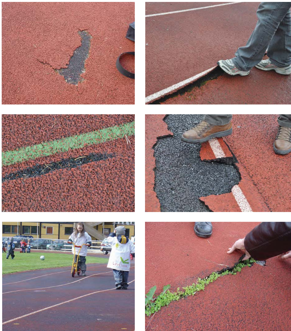
Figur 4.3.6: Øverst til venstre: Mekanisk skade forårsaket av maskiner på Aurland stadion. Øverst til høyre: Her har dekket sprekker, og det gror innunder slik at det slipper. Fra Valhalla stadion i Tromsø. Midtbilde til venstre: Furumo stadion på Geithus. Mekanisk skade kanskje fra gressklipper. Midtbilde til høyre: Snøryddingsskade fra Leknes stadion i Lofoten. Nede til venstre: Store setningskader på Atlanten stadion i Kristiansund. Nede til høyre: Her har underlaget seget, og dekket sprekker. Fra Bismo stadion i Skjåk. Foto: Ole Petter Sandvig
