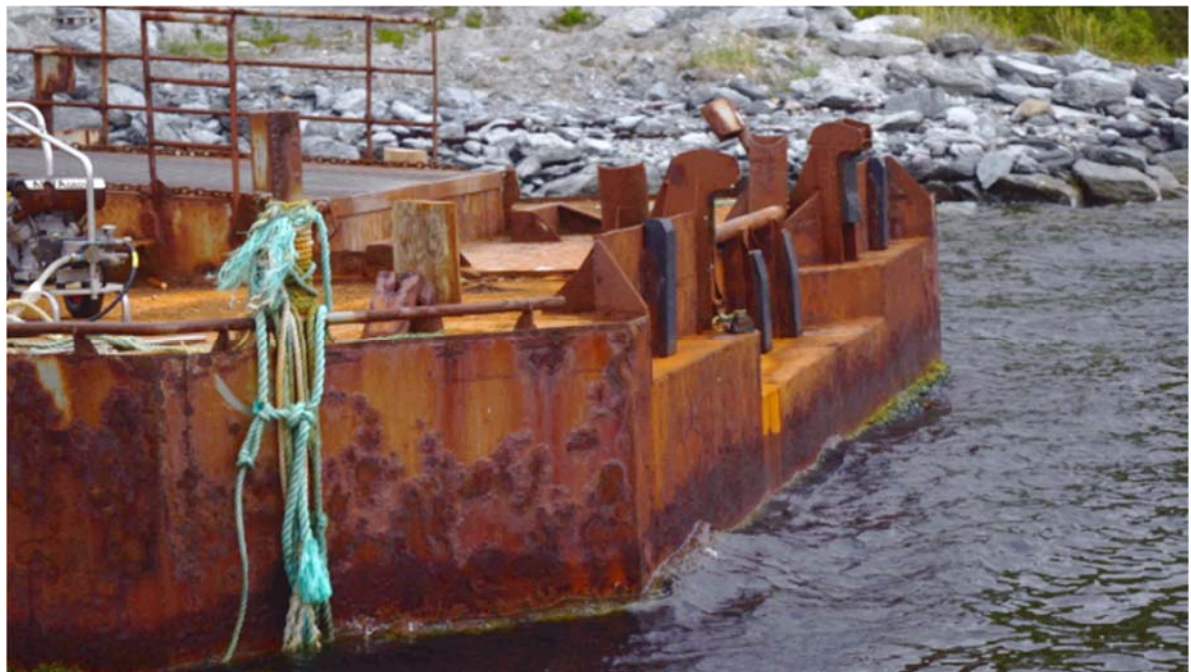
Bilde 4 – Generell tilstand pontong, front
