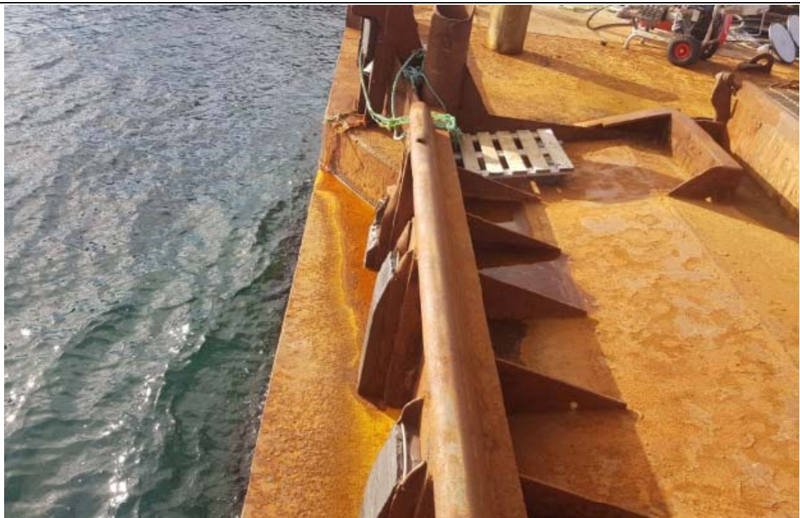
Bilde 5 – Deformasjon av ribber i front
