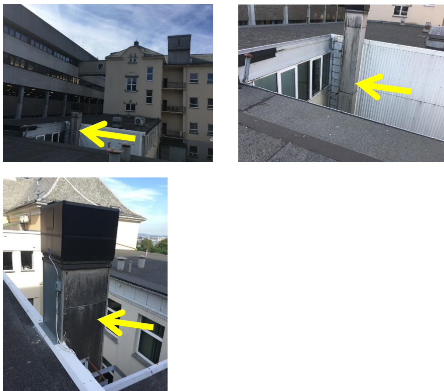
Figur 2.8: Ventilasjonskanal utvendig bygg 2
