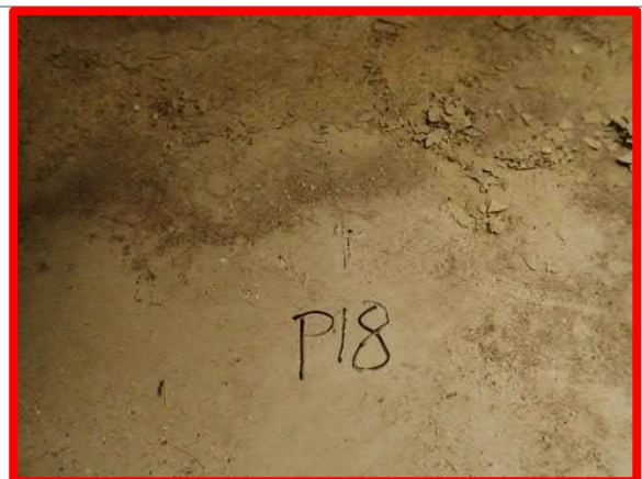
Figur 3.6.10 Grå gulvmaling i kjeller forurenset med bly.
