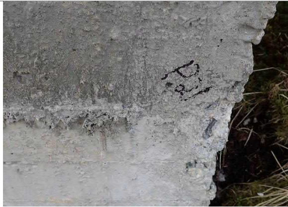
Figur 3.6.11 Betong lavforenset med krom VI.
