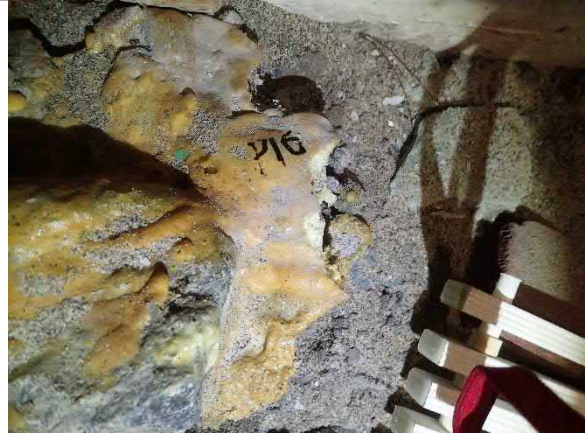
Figur 3.3.8 Injeksjonsskum lavforurenset med PCB.
