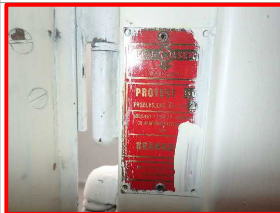
Figur 3.2.3 Brannør med sannsynlig innhold av asbest.
