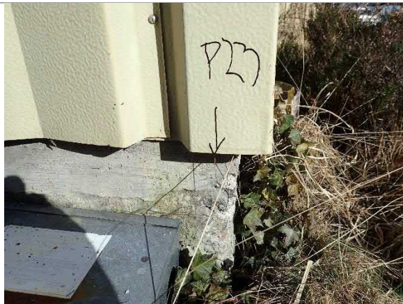
Figur 3.6.13 Betong lavforenset med krom VI.
