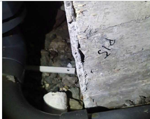
Figur 3.6.8 Betong i kjeller lavforurenset med krom VI.
