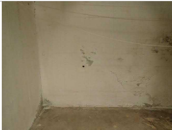
Figur 3.3.9 Hvit maling på kjellervegg lavforurenset med PCB.
