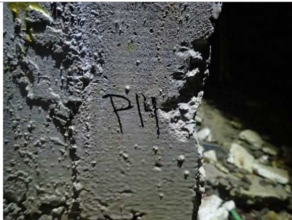
Figur 3.6.7 Betong i kjeller lavforurenset med krom VI.
