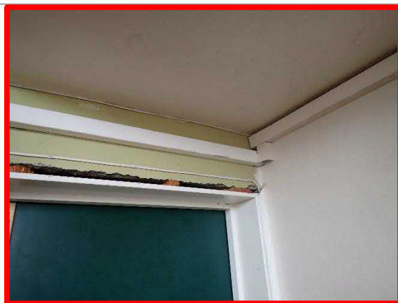
Figur 3.6.15 Deler av kabelskinne i gymsal.
