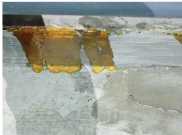
Figur 3.7.2 Eksempel på avrenning ved injeksjonsskum.
