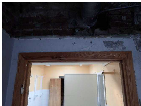
Figur 3.6.3 Murpuss lavforurenset med krom VI.
