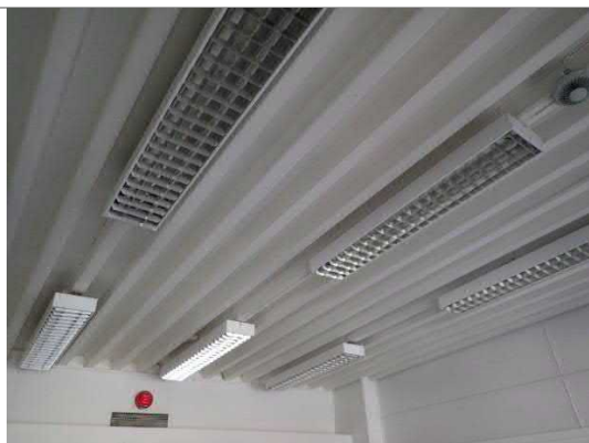
Figur 3.12.1 Eksempel på lysarmatur med lystoffrør og brannvarslere (på bakvegg).
