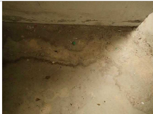
Figur 3.3.10 Grå maling på kjellergulv lavforurenset med PCB.
