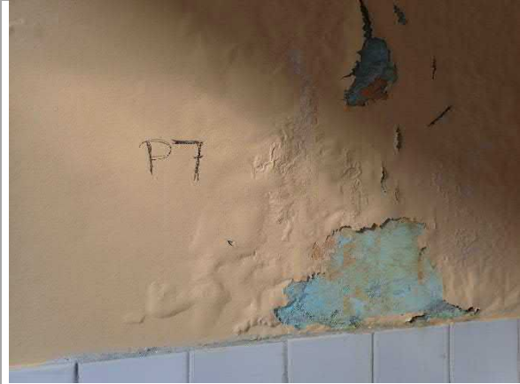
Figur 3.3.2 Gul maling på dusjvegg lavforurenset med PCB.
