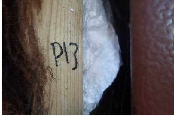
Figur 3.3.7 EPS i vegg lavforurenset med PCB
