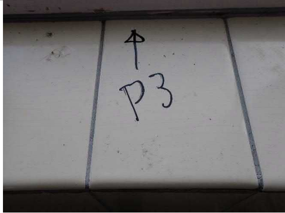
Figur 3.3.1 Fuge under vindu lavforurenset med PCB.
