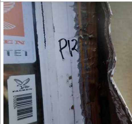
Figur 3.3.6 Fugemasse rundt vindu lavforurenset med PCB.
