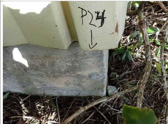
Figur 3.6.14 Betong lavforenset med krom VI.
