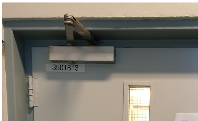
Figur 3. Dørpumpe på heisdør
