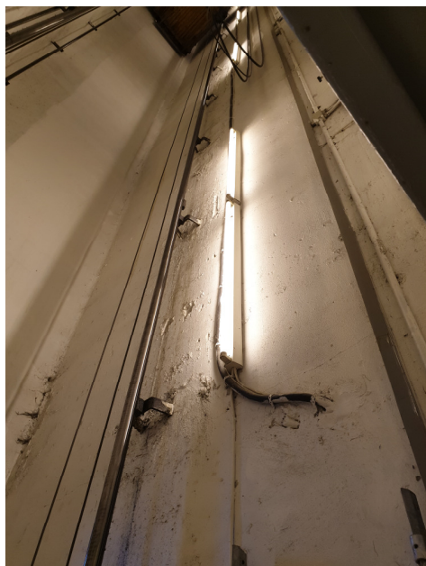
Figur 4. Lysstoffrør i heissjakt
